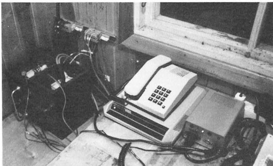
Her er utstyret som formidler informasjonen inn til vegkontoret. Foto: W.B.
