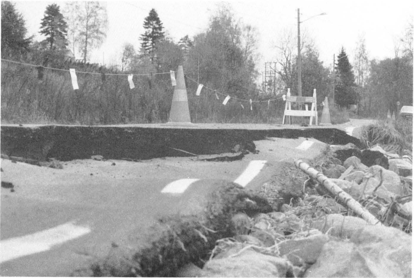
Enkelte vegstrekninger ble en del bulkete etter uværet, spesielt i den nedre delen av fylket.
