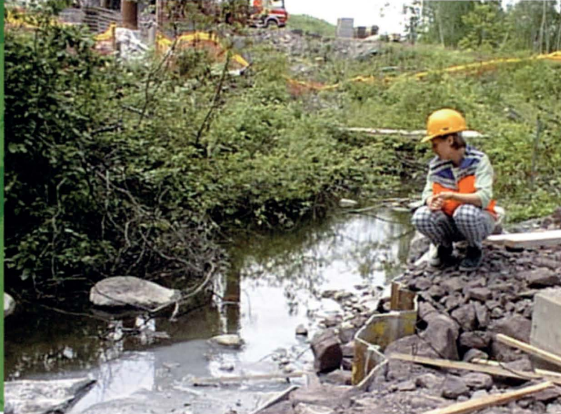
Bekymret byggeleder Grethe Bodholt følger opp tilslamming av Mofjellbekken. Foto hentet fra «Rapport for miljøoppfølging i anleggsfasen»
