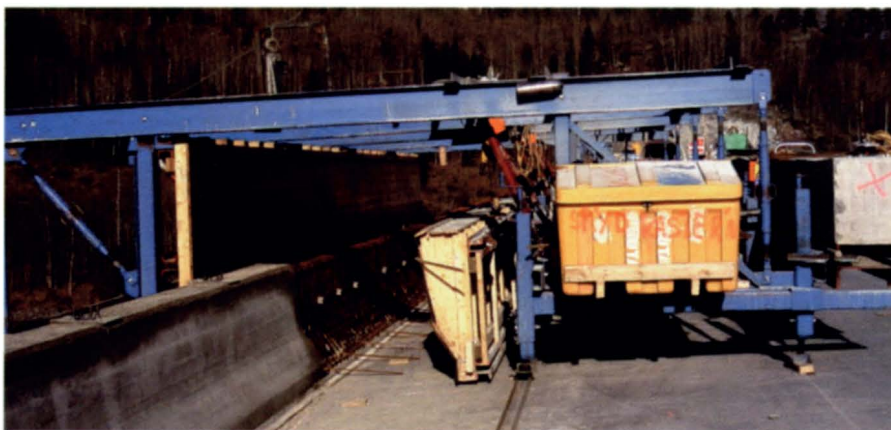
Betongrekkverket støpes med denne maskinen. Den lager 11 meter rekkverk om gangen og bruker 3 måneder på å jobbe seg over brua.
