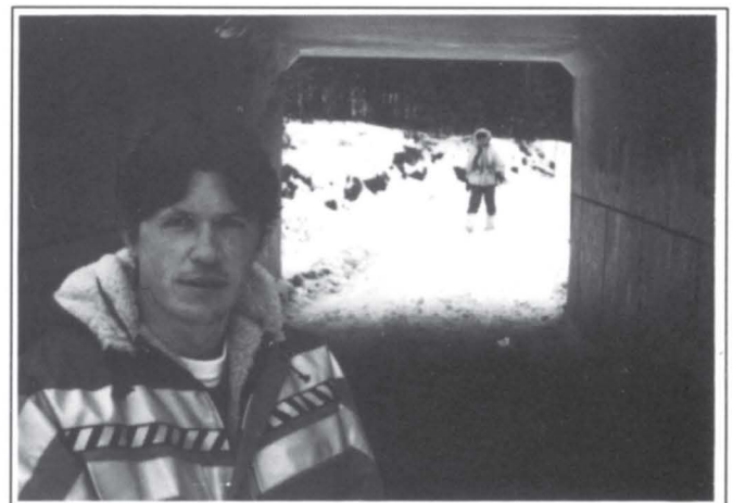
Undergangen ved Greveskogen mangler tilstrekkelig sikt.
