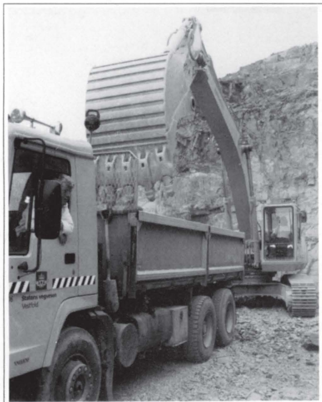
Fjellsprenging og utkjøring av masser i Hallanåsen pågår og her ser vi Jermund Bjørge (i lastebilen) og Helge Knutsen.
