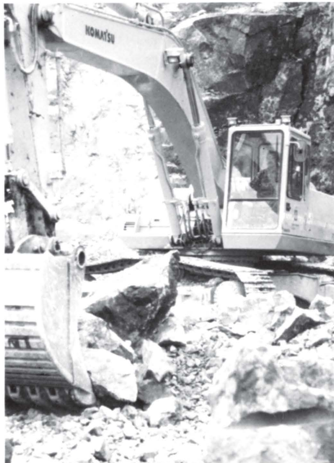
Mye sprengning i Hallanåsen gjør at det er behov for to gravemaskiner i fjellet. Her ser vi Helge Knutsen igang med fjerning av steinmassene.
