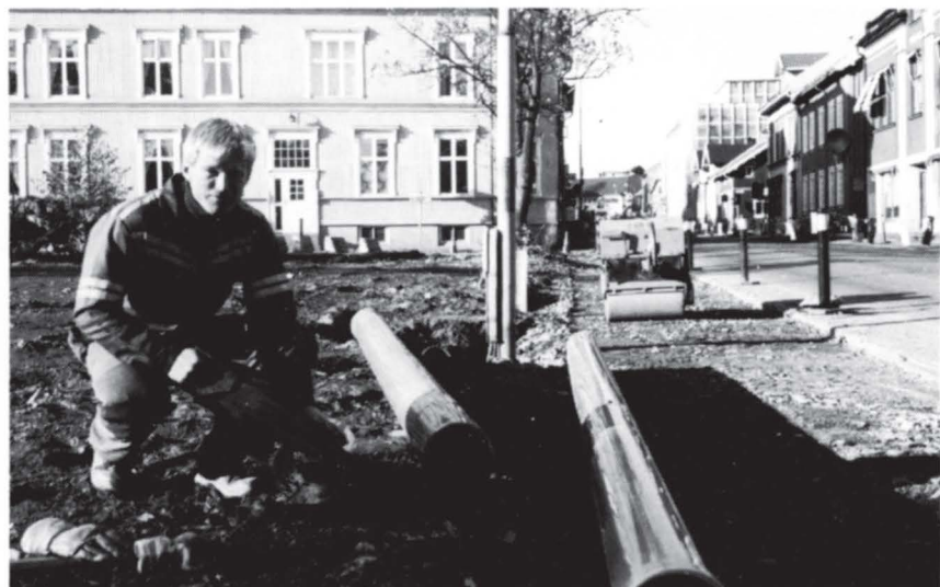
Espen Sørлие er her i ferd med å tilpasse rør til vannledningen under g-/s-vegen i Stoltenbergsgate som bygges i forbindelse med sykkelbyprosjektet Tønsberg/Nøtterøy.
