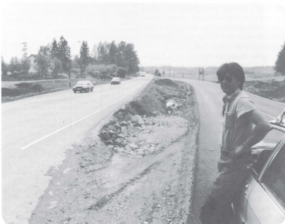
Interimsvegen ved Furulund ble brukt ved omlegging av vann- og kloakkledningen i mai. Vegen skal benyttes igjen til høsten. På bildet: oppsynsmann Dag Runar Haugen
