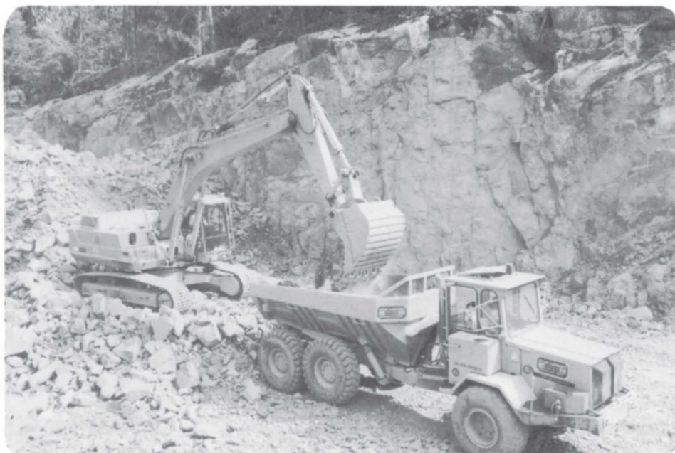
I Ramsu- måsen går arbeidet med fjellskjæringa for fullt. Massene brukes i linja sørover forbi Skjee kirke til Gjennestadmyra bru.
