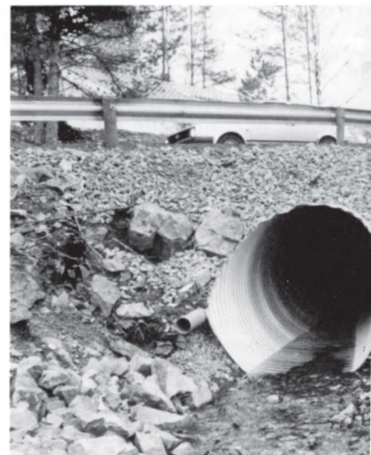
Dimensjonene sier litt om de vannmengdene som skal gjennom Liverødvegen være klar til en ny slik «hundreårs-flom».
