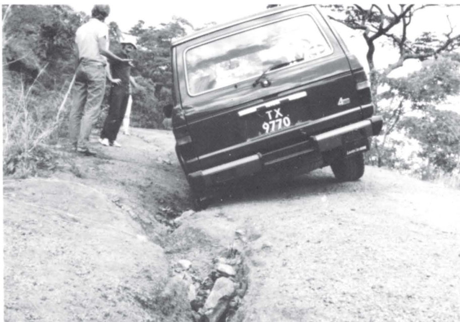
Vegvedlikehold er svært viktig også i Tanzania. Tidligere har man vært med opptatt av å bygge nye vegger enn å vedlikeholde gamle.
