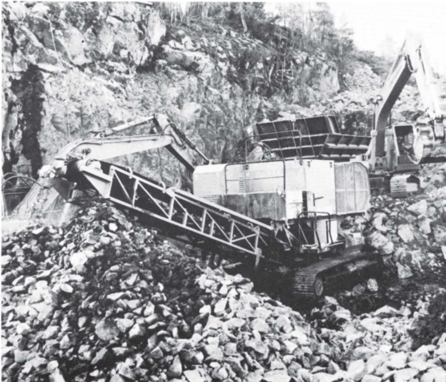
Vi er nå igang med prøvedrift på sprengning og knusing av fjell til forsterkningslag på den nye E-18 i Sem.
