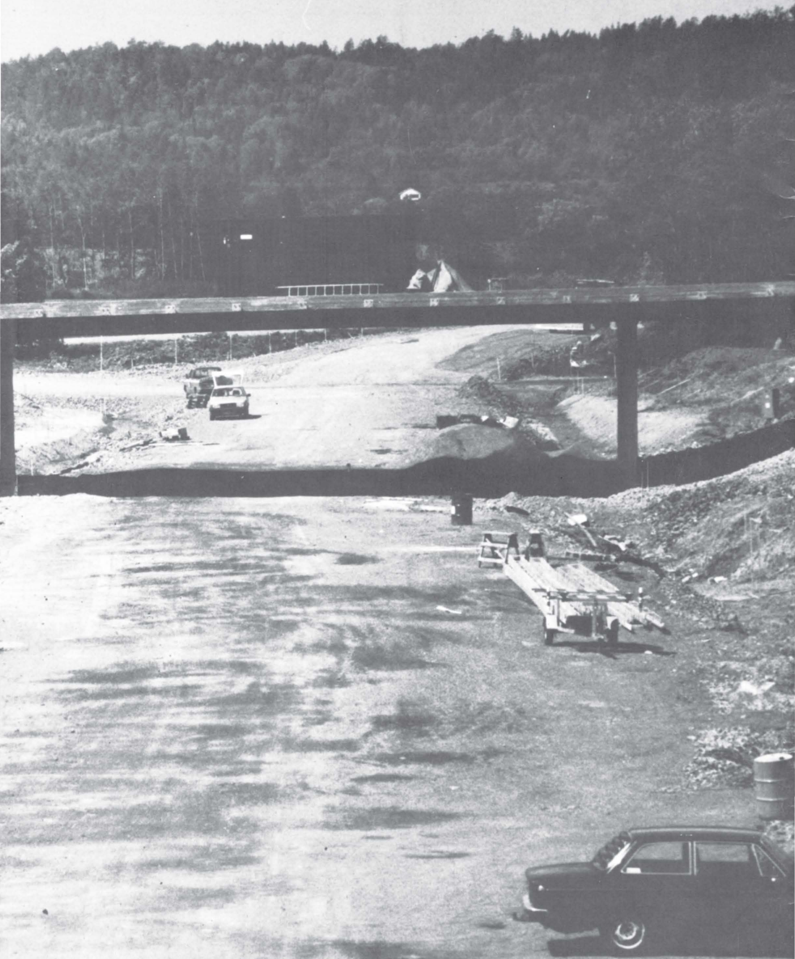
Den nye Bispeveien åpnes 1. juli. Da er de største trafikkproblemene i krysset ved Jarlsberg Vertshus løst.
