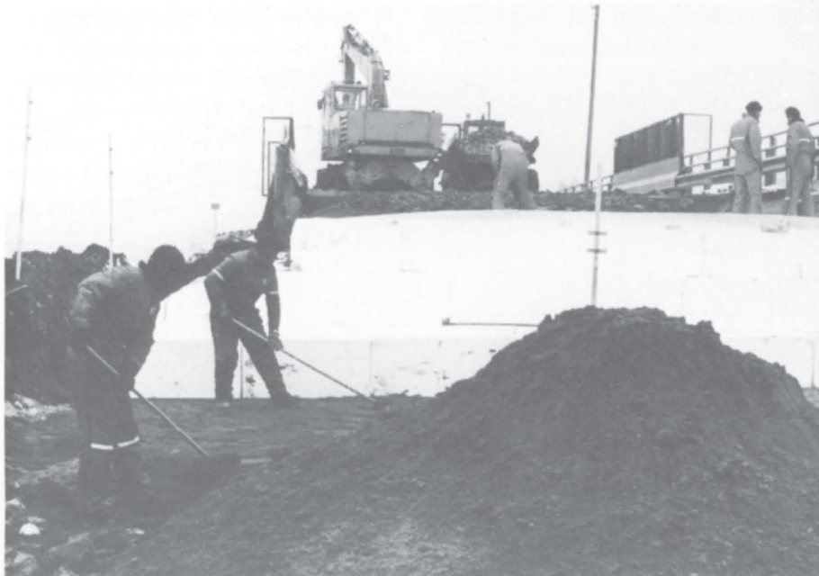
Som erstatning for steinmassene blir det benyttet blokker av ekspandert polystyren (isopor) til gjenoppbygging av vegen.
