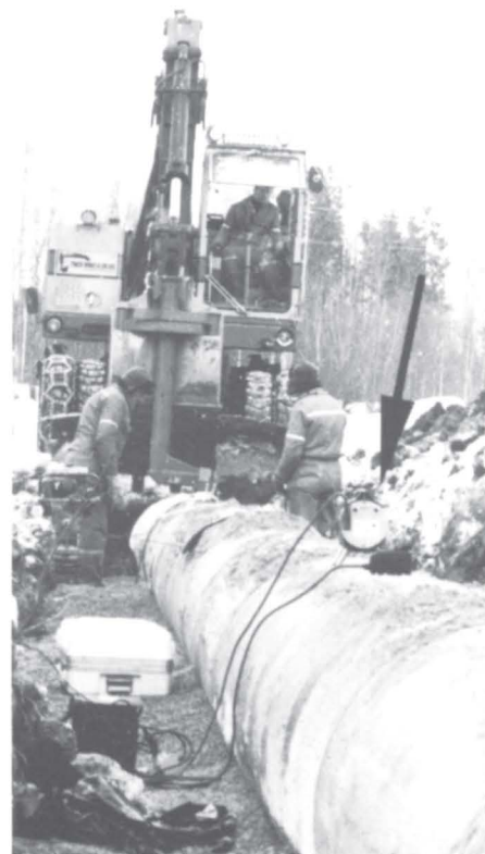
Da flomvannsledningen syd for Foksrød ble lagt ned, nyttet anlegget laser i jobben (pilen viser laserens plassering).
