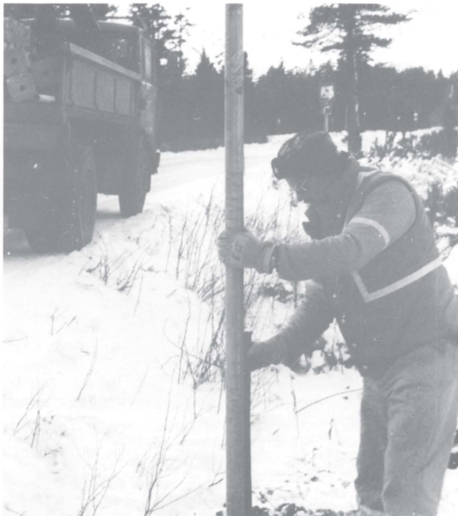
Et historisk øyeblikk. Erik Jespersen på skiltavdelingen setter ned den første kilometreringsstolpen på f.v. Z-51 i Brunlanes.
