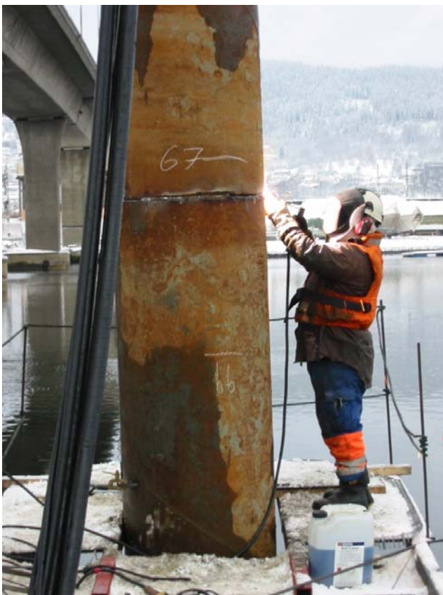
Figur 20 Sveising av stålrør. Stålrøret er merket for hver meter med krittmerke. Arbeidshøyden er litt høy, og dermed ubekvem for sveiseren.
