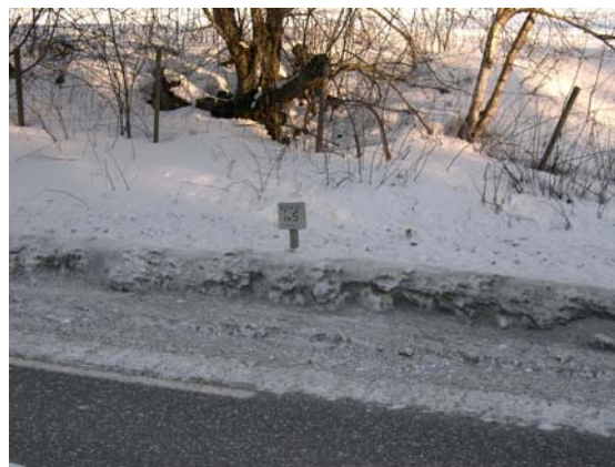
Figur 11: Slik skal ikke en referansestolpe settes opp. 30 cm høy stolpe på skulderkanten er ikke i henhold til retningslinjene.
