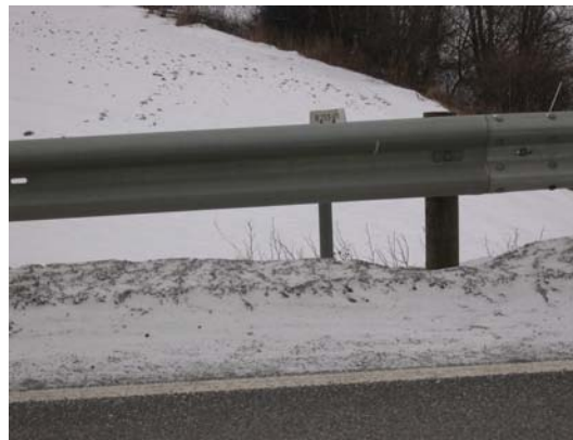
Figur 10: Denne stolpen er minst en halv meter for lav og burde vært byttet.
