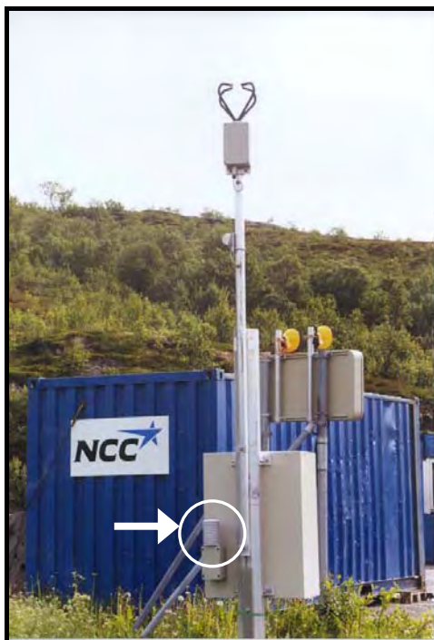
Figur 9. Et eksempel der sensoren for lufttemperatur er plassert for nærme elektronikkskapet.
