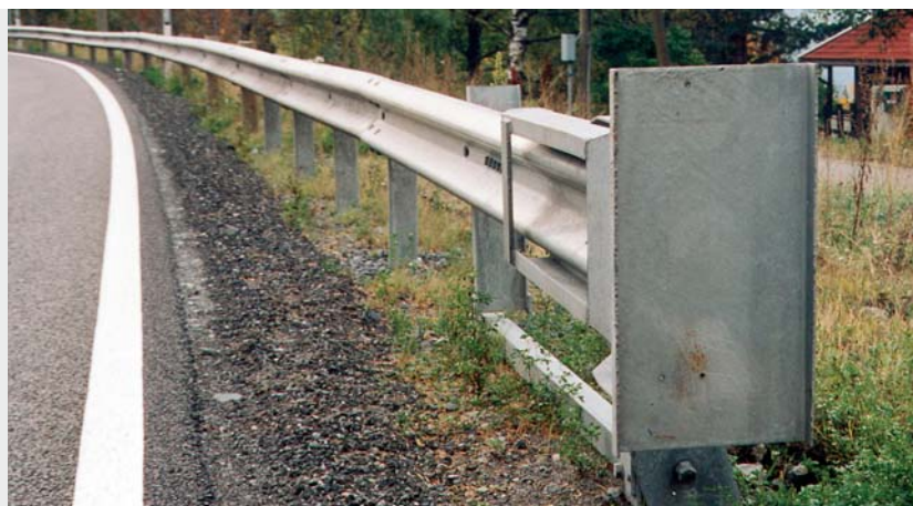
Skarpkantet ettergivende rekkverksavslutning som kan gi stor skade på en motorsyklist.
