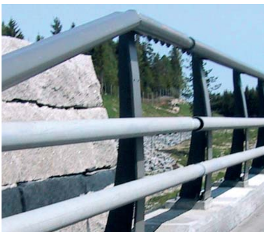
Rekkverk med skarpe kanter og uheldig avsluttet føringskant.
