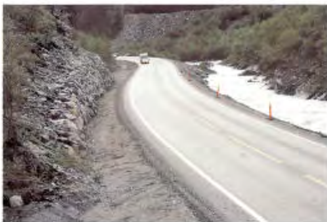
Det kan være vanskelig å innpasse en veg med høy standard i en trang dalbunn. Inntrykket av en fin mur forstyrres her av en ødelagt strandsone. E6 i Drivdalen, Sør-Trøndelag. Foto: Sunniva Schjetne
