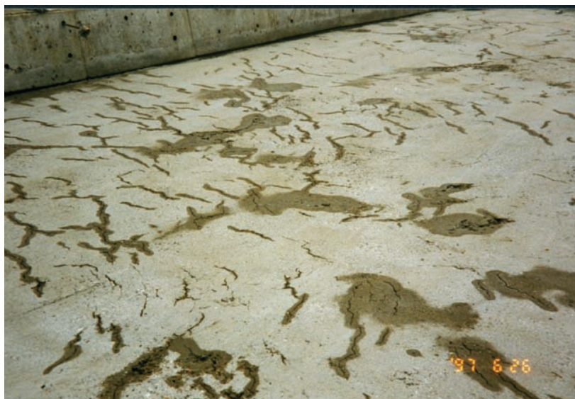
Fig. 3.2 Eksempel på alvorlig opprissing forårsaket av plastisk svinn (foto: Reidar Kompen, Statens Vegvesen)
