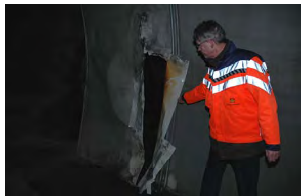
Figur 15 Storvikskartunnelen. Revne i tunnelduken fra påkjørsel.
