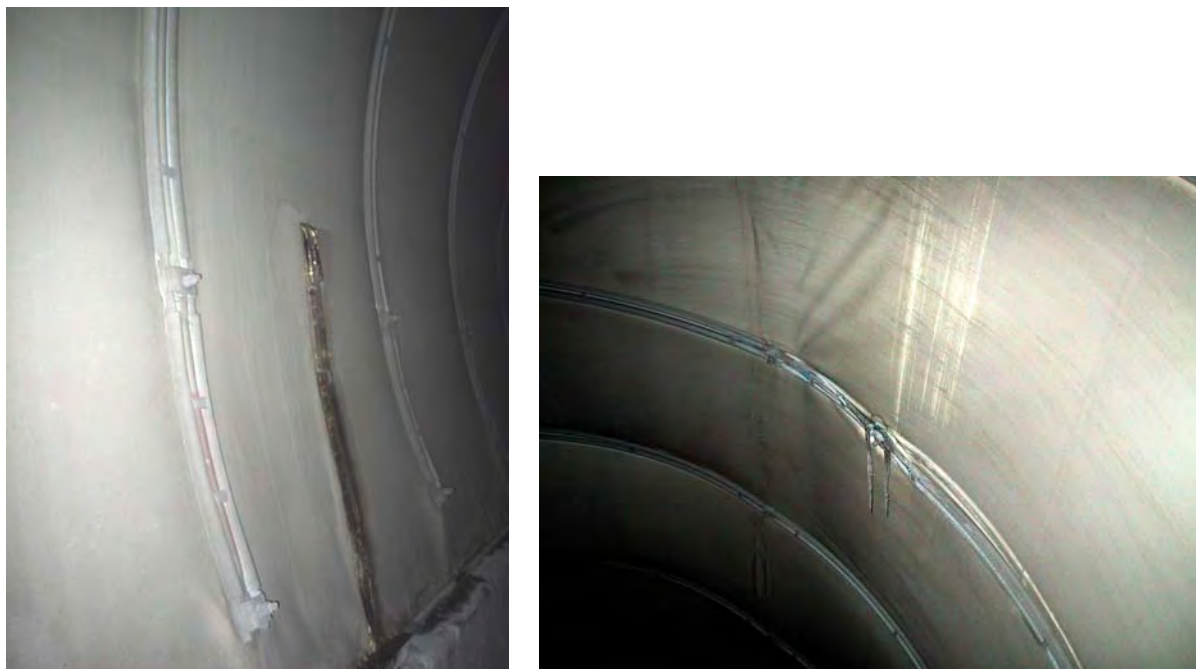
Figur 16 Haukelitunnelen i 2002. Eksempler på riftskader fra kjøretøy som gir isdannelse i tunnelen.
