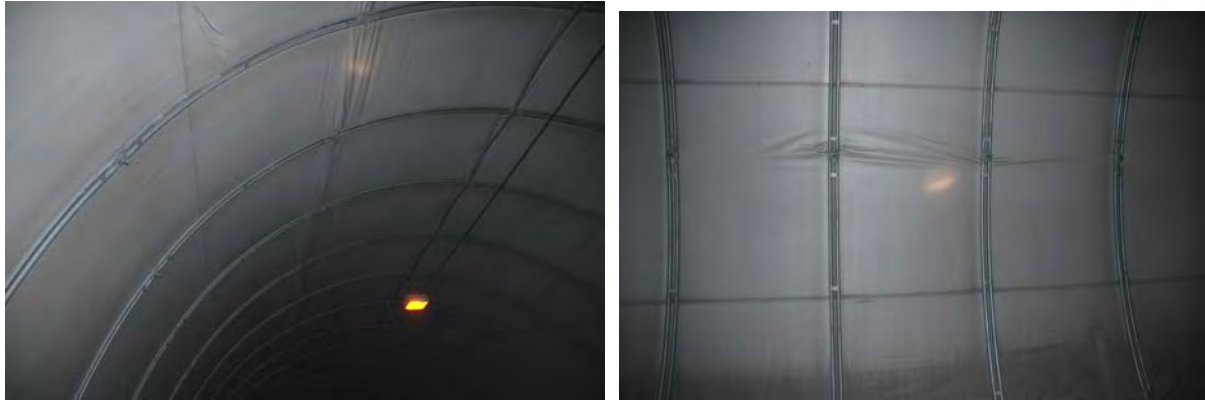
Figur 12 Storvikskartunnelen. Eksempel på horisontale sammenhengende bulker i hvelvet. Det kan være fare for at bulkene er utsatte slitasjepunkter eller punkter for oppsamling av forurensning. Samme type bulker ble observert også i Bjørøytunnelen.
