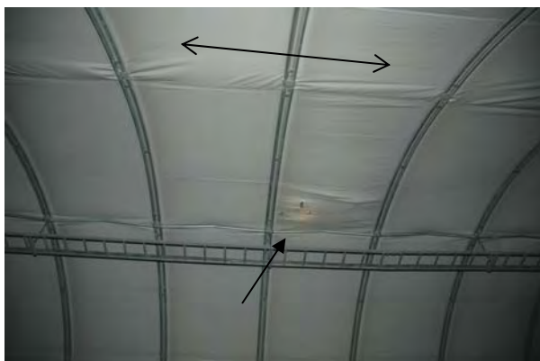
Figur 14 Storvikskartunnelen. Nedfall av stein i taket har nesten perforert tunnelduken. Merk også langsgående bukling i hvelvet.
