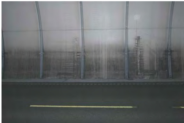
Figur 7 Bjorøytunnelen. Markert kant av konsentrert trafikkstøv nederst på veggen. Merk de to inspeksjonslukene i hvelvet, L-formet og lukket med glidelås.
