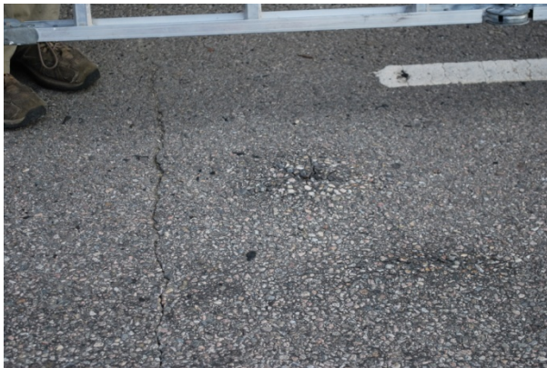
4-1516 Evenstad – ”paddehatt” i asfalten
