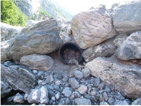
Figur 3. Tilknyttet drenering med skader.
