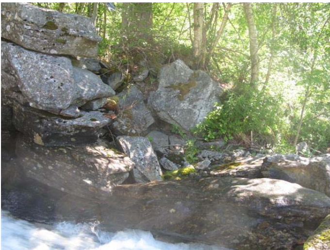
Figur 4 Bildet viser at deler av tørmur har rast ut.
