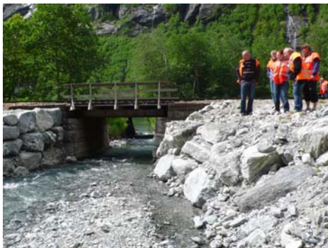
Figur 1. Deler av erosjonssikring med skader.
