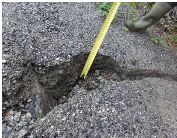
Figur 7 Stikkrenne 3 780. Synlig erosjon rett til høyre for vegkant
