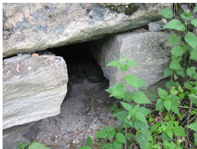
Figur 10 Stikkrenne 2 392. Utglidning av steinblokker ved utløp
