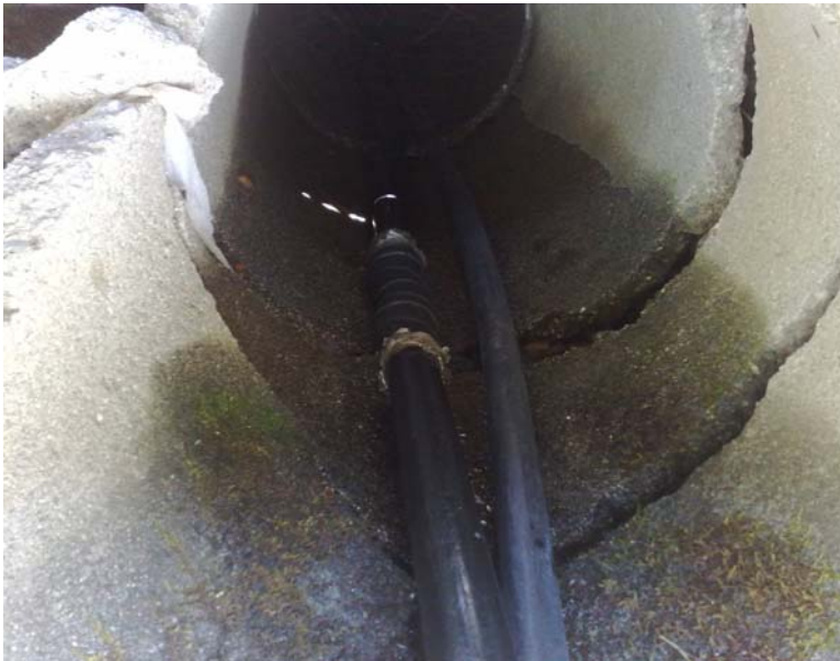
Figur 11 Stikkrenne 3496. Knust utløp i betongrenne.
