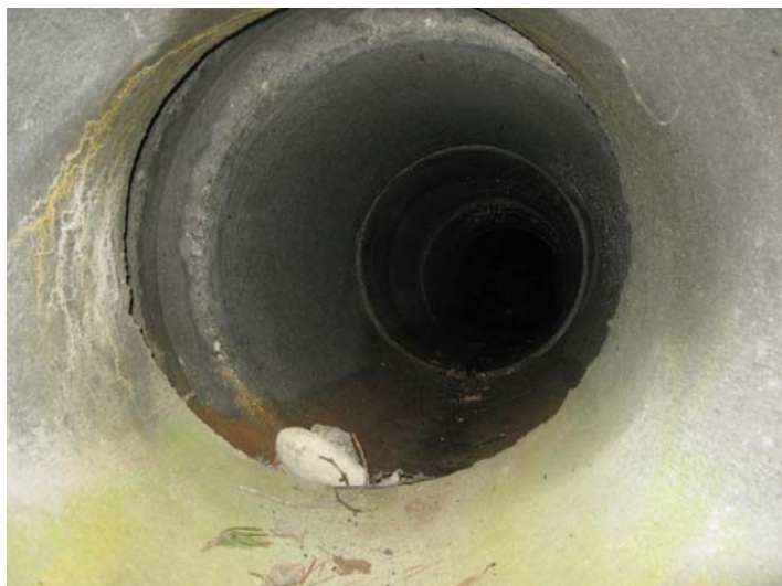
Figur 9 Stikkrenne 2 285: rør som glir fra hverandre nær utløp.
