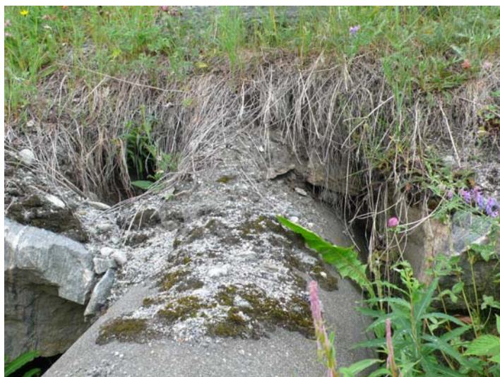
Figur 8 Stikkrenne 1 779. Setninger ved utløp
