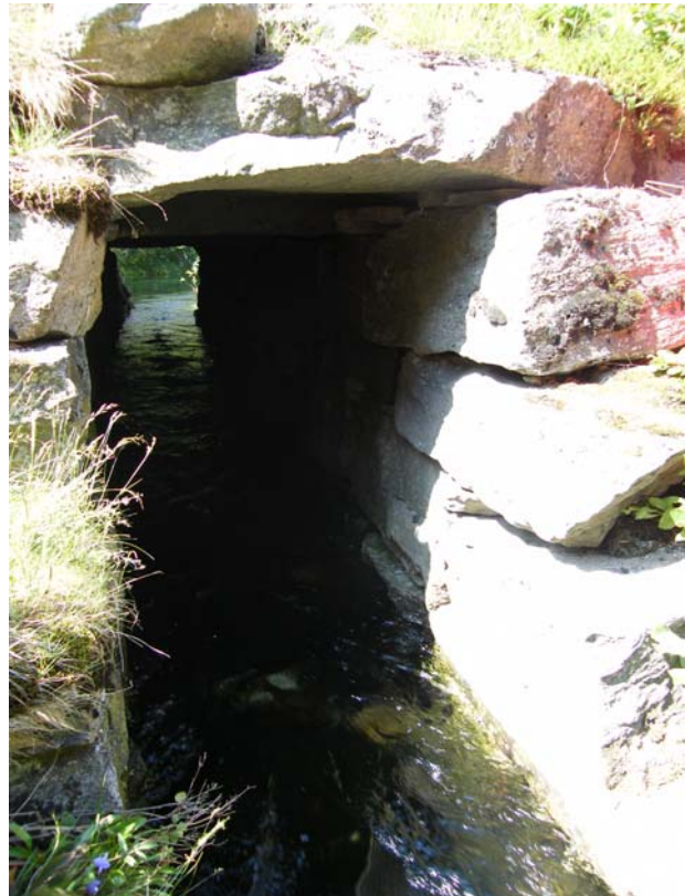
Figur 13 Stikkrenne 15 740. Typisk eksempel på en god stikkrenne i området.
