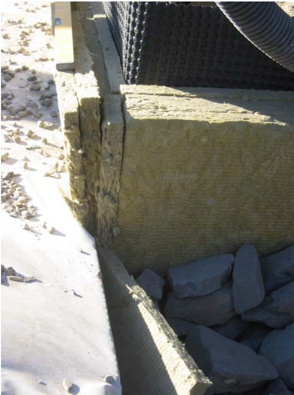
Rockwool Brannplate 50 er sammentrykt mellom husmur og jordarmert konstruksjon med betongstein (under jordarmeringa) i fronten
