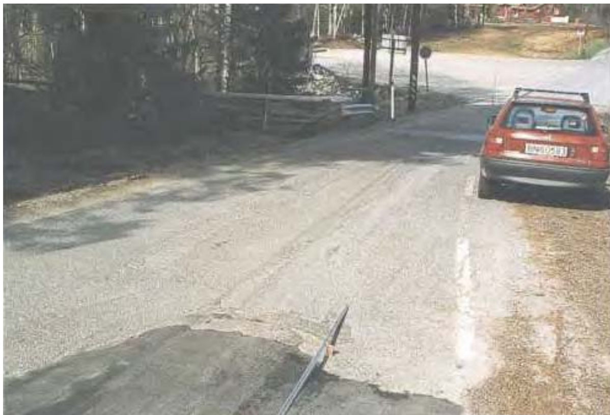
Figur 3.5 Ujevne telehiv hvor stikkrennen krysser kjørefeltet.
