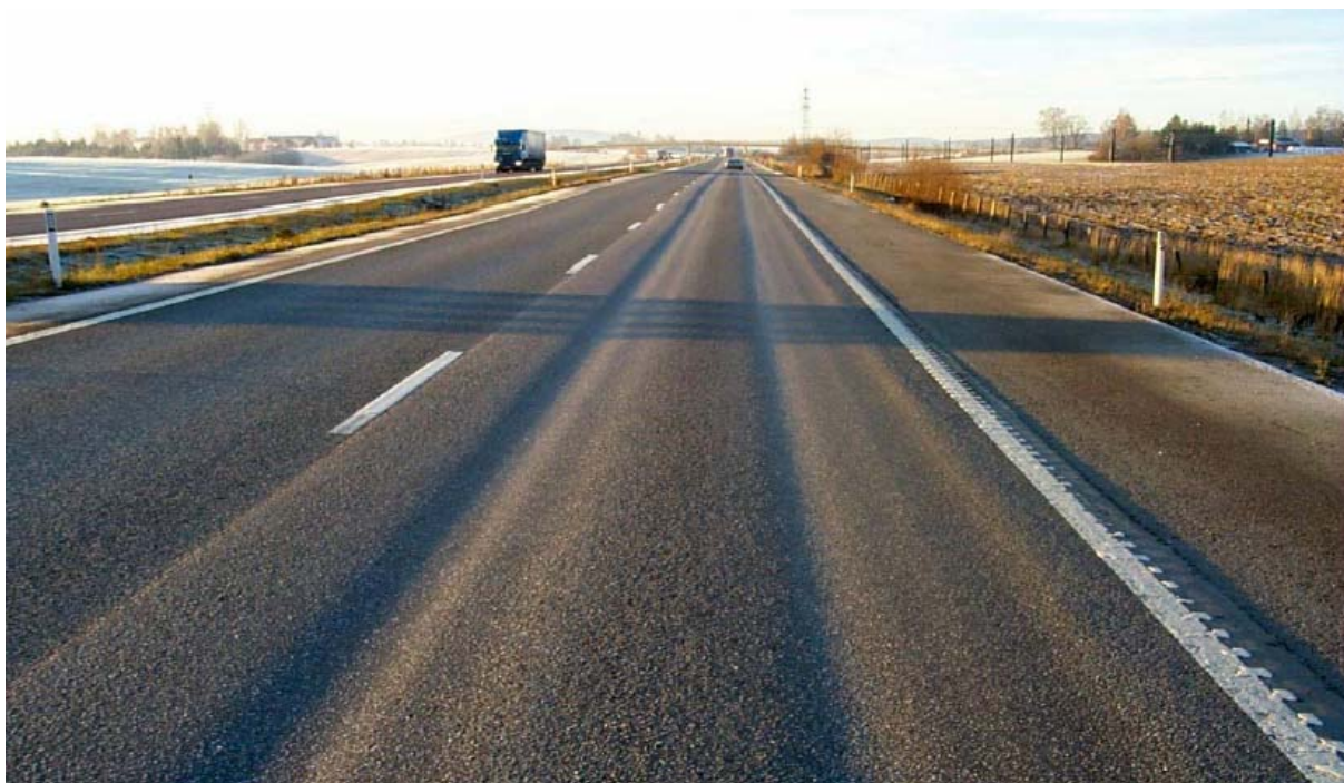
Figur 3.1 Spor ved piggdekkbruk og generell slitasje.
