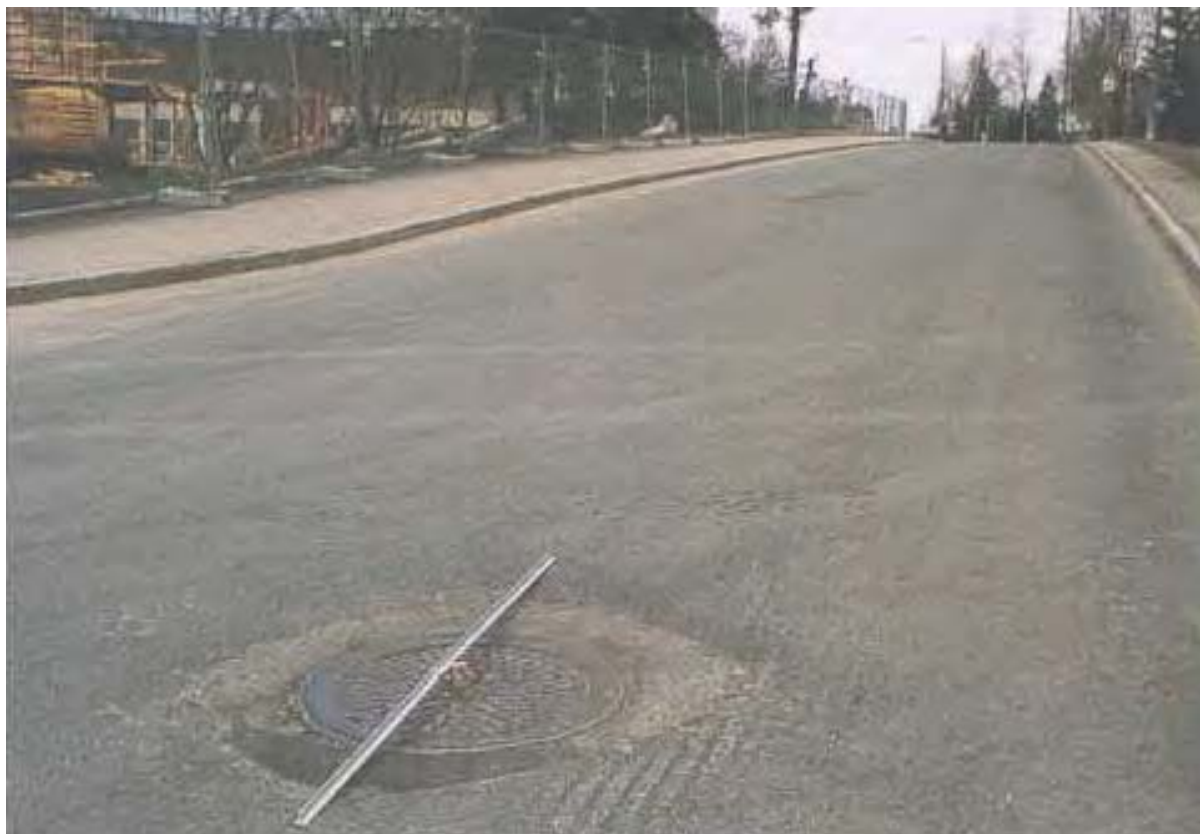
Figur 3.6 Setningsskader rundt en kum.
