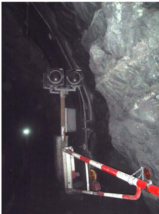
Bilde 6.9 Kolonneoppstillingsplass i Austmannalitunnelen
