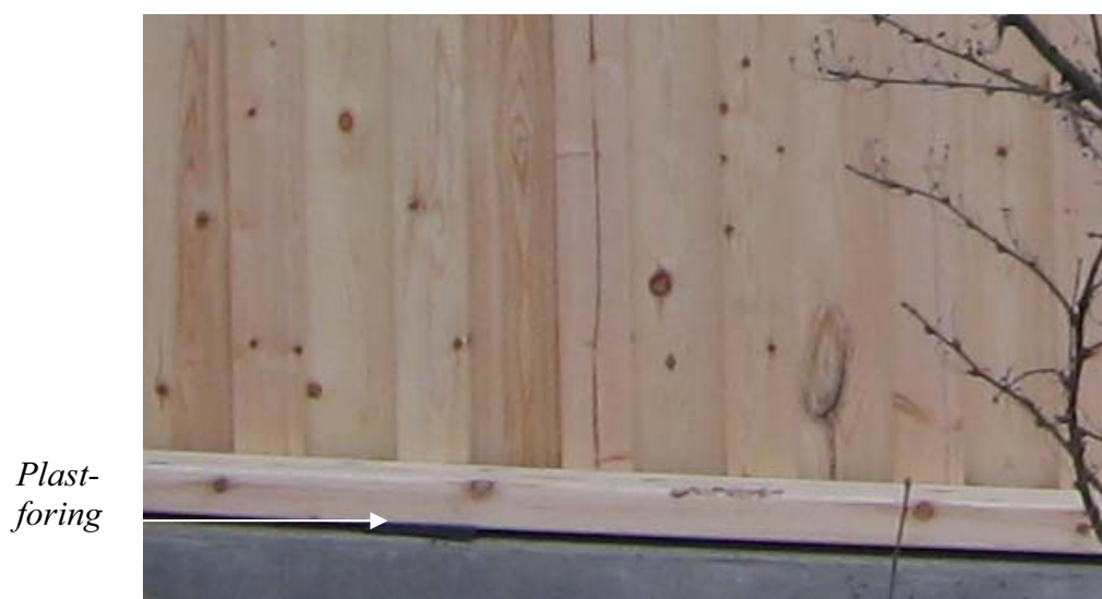
Figur 9. Punktvis plastforinger mellom bunnsvill og fuktledende betongfundament hindrer fuktvandring opp i trekonstruksjonen og sikrer rask opptørring av bunnsvill. Foto: F. Fjærtoft
