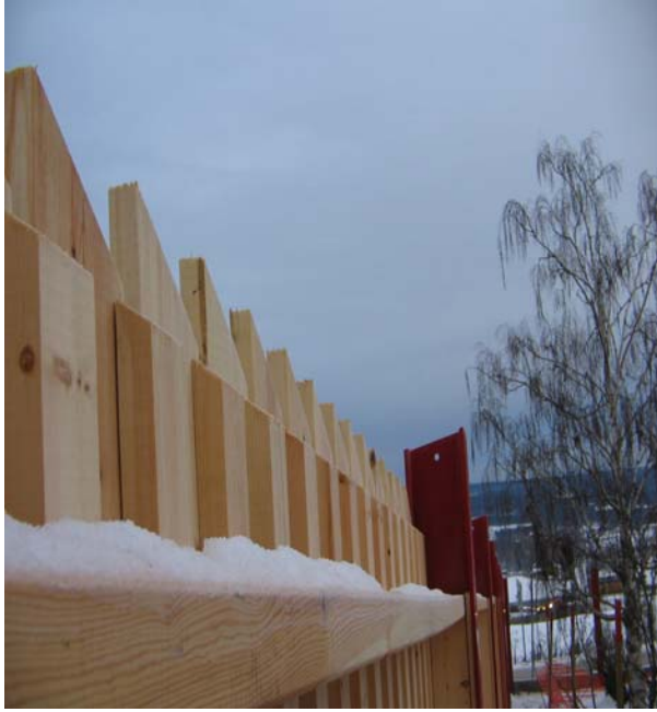
Figur 5. Tverrveden er skråskåret både på under- og overligger på den omvendte lektekledningen.
