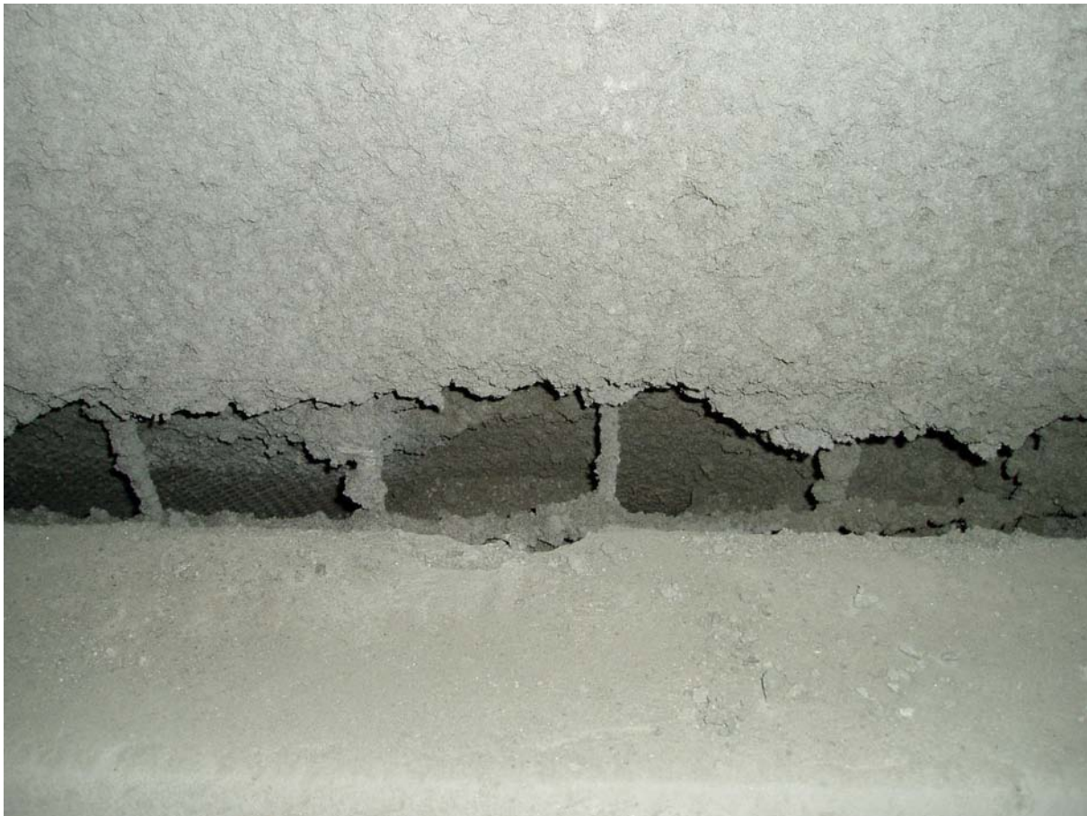
Foto 1 Område med mangelfull utsprøyting
