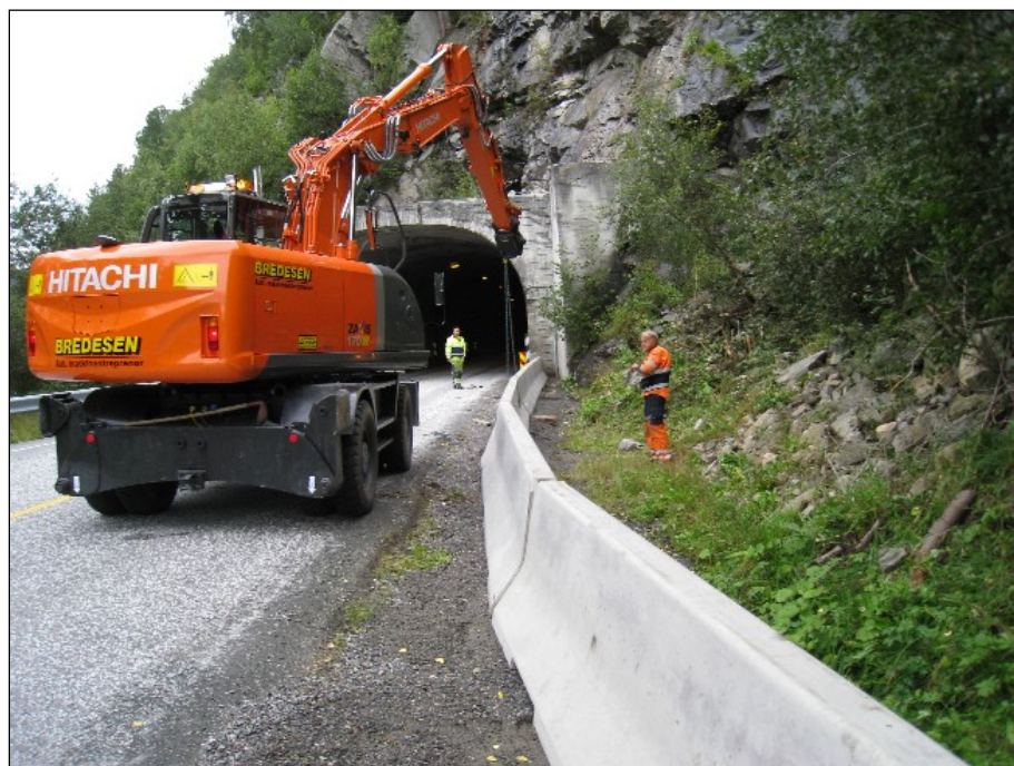
Figur 15: Ved sørlige påhugg av Trettøytunnelen ble det utført rensk og etablering av ledekant for å hindre nedfall av mindre blokker på veg (foto: Mesta Drift AS).
