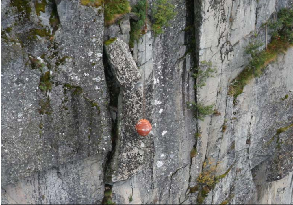
Figur 17: Airlift AS utfører sleggerensk i det bratte løsneområde 400 m over dagstrekningen mellom Midtbekktunnelen og Trettøytunnelen (lok. B2-2, jfr. fig. 14). (Foto: Statens vegvesen)
