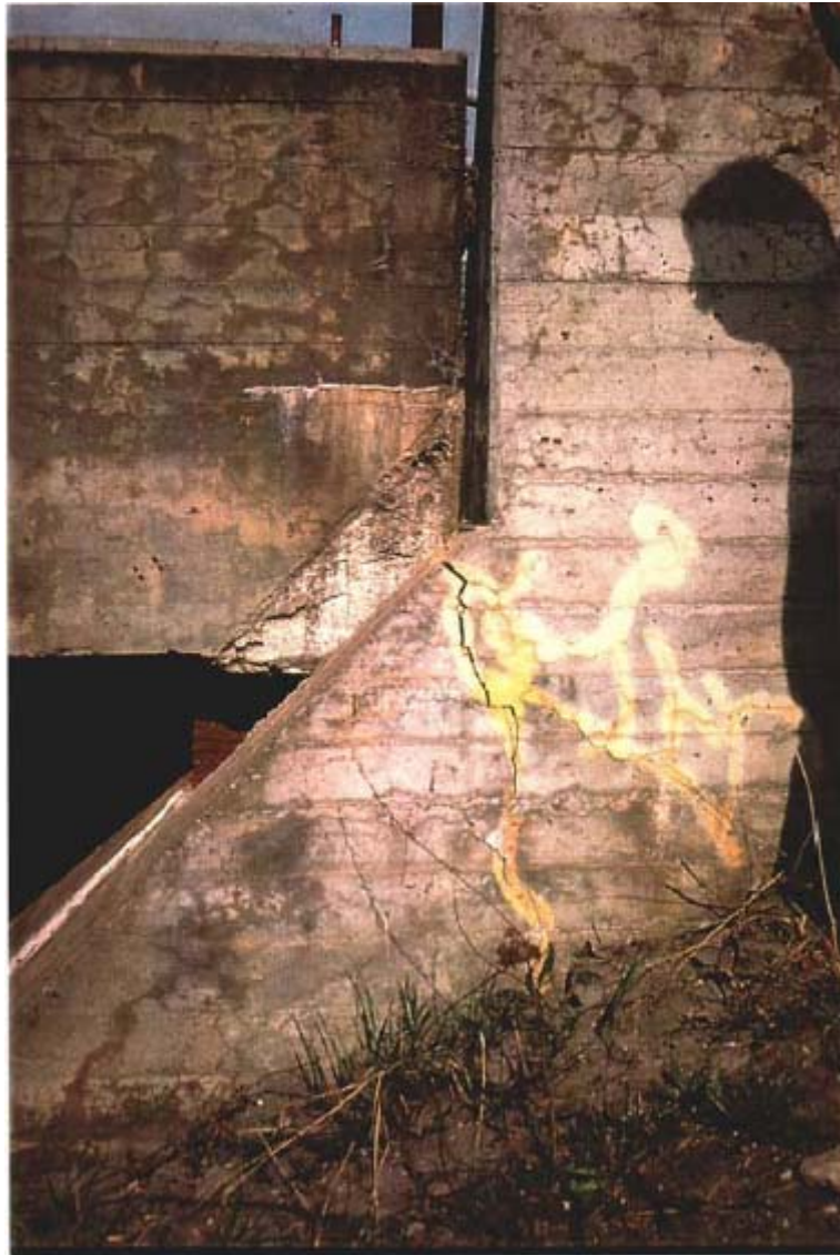
Fig.4. Overbygning har presset mot landkar slik at dette har sprukket. Bemerk også den improviserte opplagringen.
