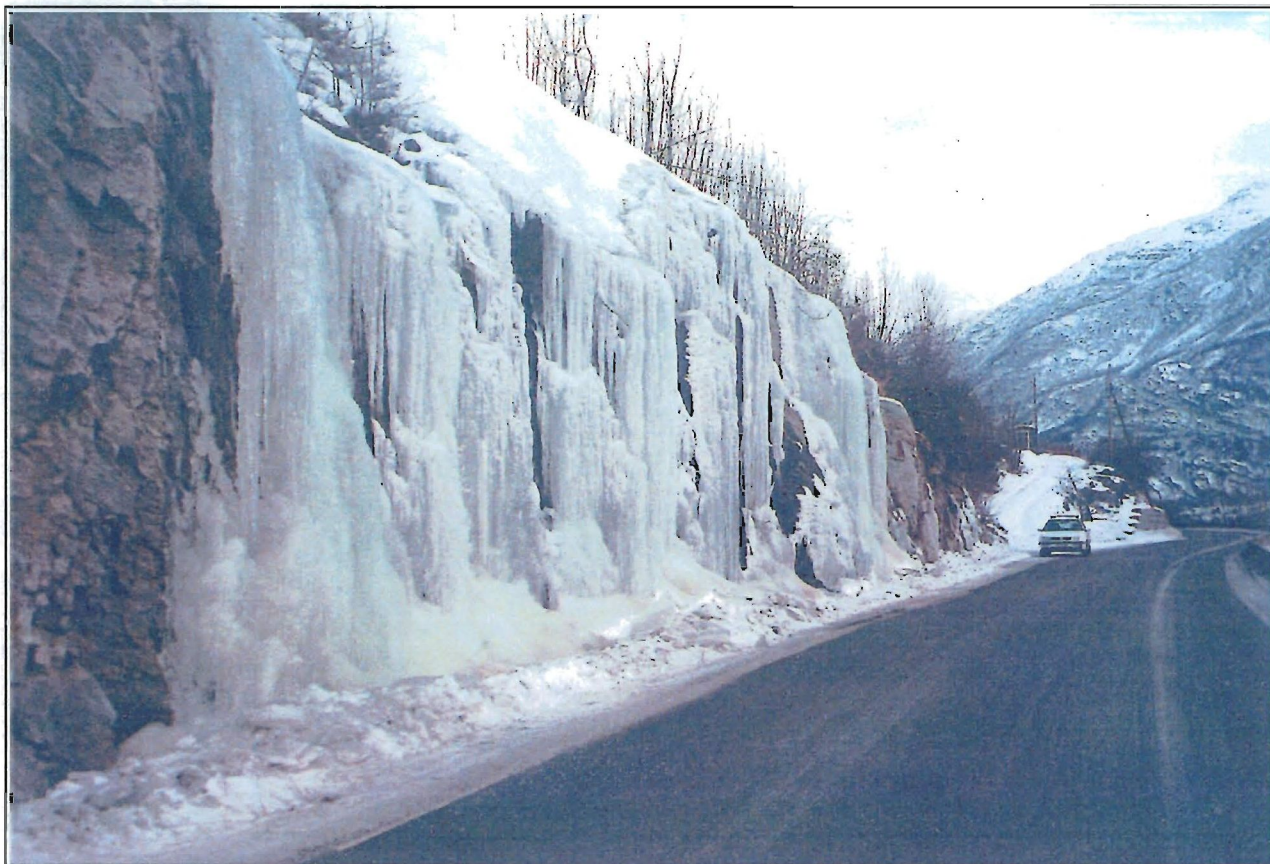
Fig. 11 Fjellskjeringar utsette for iskjøving ligg oftast nedanfor ei fjellside dekt med lausmassar eller med eit vassjukt vegetasjonsdekke. Ein vesentleg del av sigevatnet fylgjer skiktet mellom fjellet og lausmassane, og frys til is der vatnet vert pressa fram i dagen. Kjøvinga fyller i mange høve grøftene og gror då vidare inn i vegen. Rv 550 Kråkevik.
