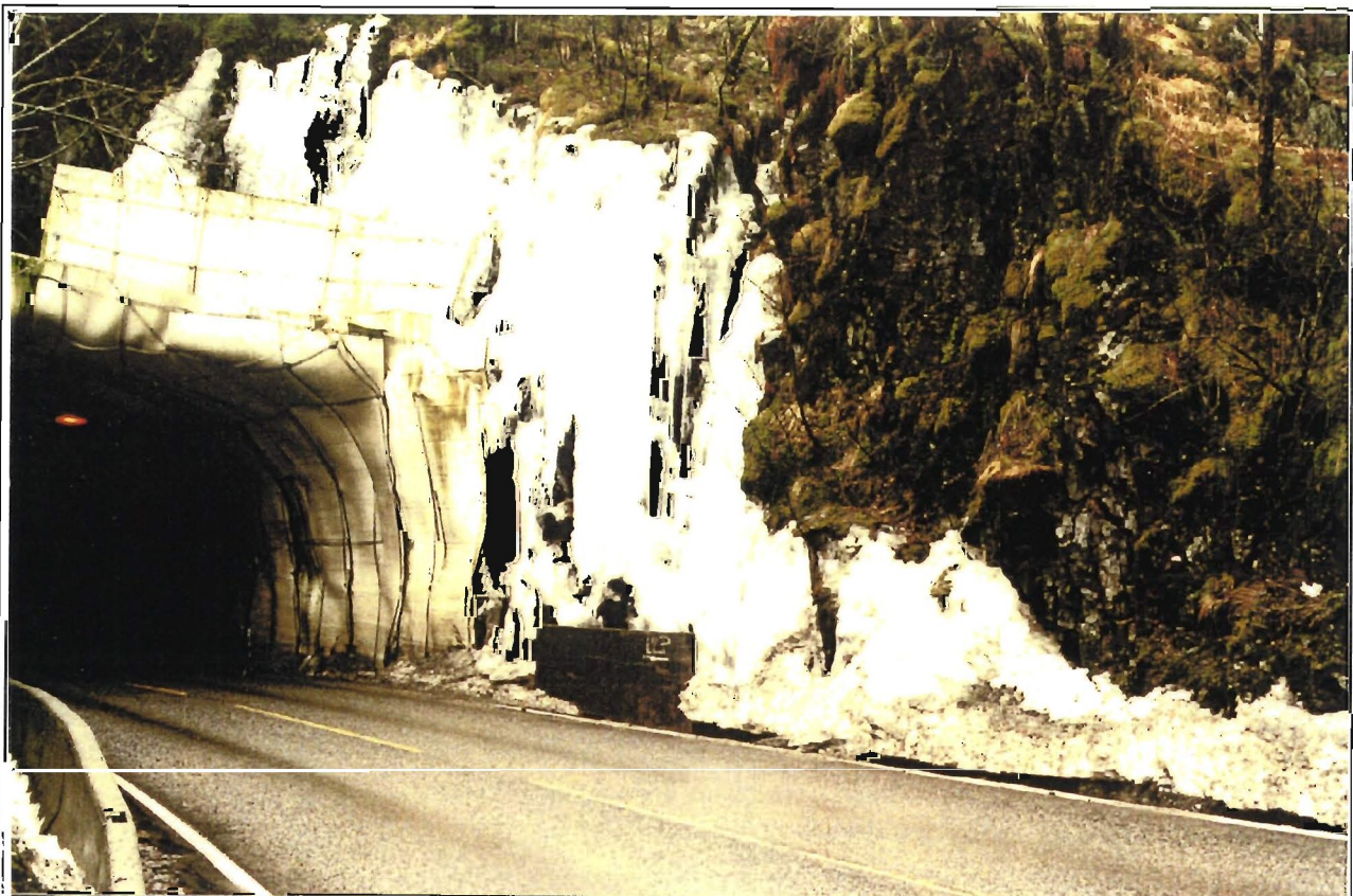
Fig. 56 Tunnelmunningar er særleg utsett for iskjøving og nedfall av is. Problema med vatn og is gjev stundom spesielle og estetisk sett lite gode løysingar. E16 Kjenestunnelen.
