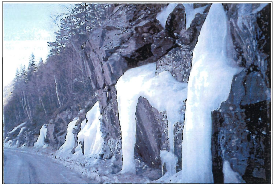
Fig. 12 Opne sprekker i fjellet kan gje store iskjøvingar. Fv 651 Svineroi.
