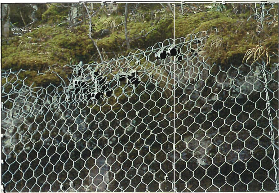
Fig. 41 Nettet vert bretta inn og festa med ein gjennomgåande wire til augeboltar i toppen av nettet. E39 Halså.
