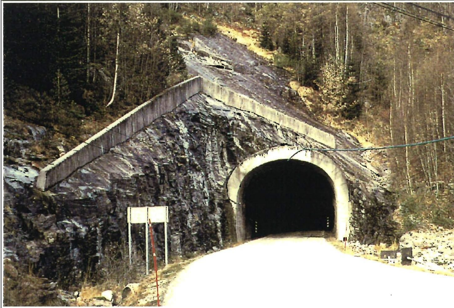
Fig. 58 Murane kunne med fordel vore erstatta med terrenggrøfter. Grøftebreidda ved tunnelmunning er også i snauaste laget. Fv 346 Modalstunnelen .
