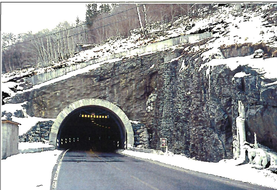
Fig. 59 Breie grøfter inn mot tunnelen og fangmur over tunnelpåhogget reduserer faren for iskjøving og nedfall av is i vegen. Rv 15 Hjelletunnelen.
