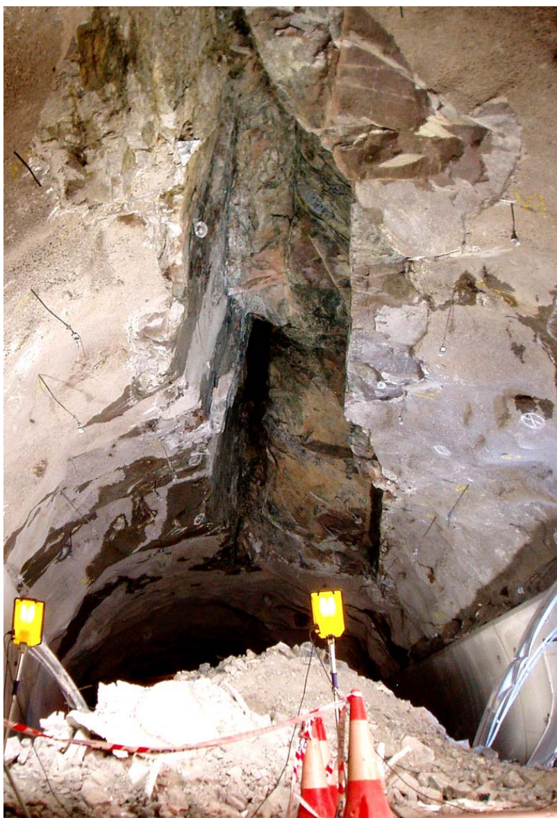
Figur 4. Oversiktsbilde som viser utstrekning av det nedraste partiet i tunneltaket.
