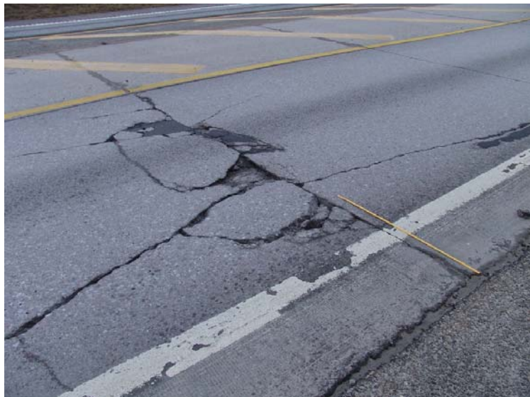
Stor skade ut fra dagskjøt i betongdekket
