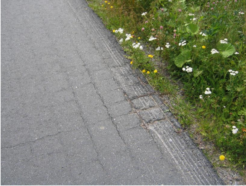
Bild 3. Stålnätet har kommit för nära beläggningssytan med nedbrytning som följd.
