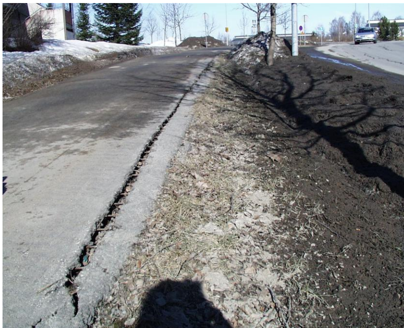
Bild 2. En längsgående spricka som har utvecklats vid stålnätskanten.
