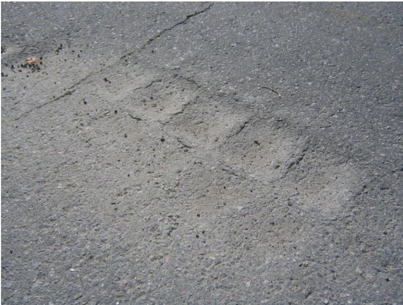
Bild 4. Beläggningens underbyggnad har givit efter.
