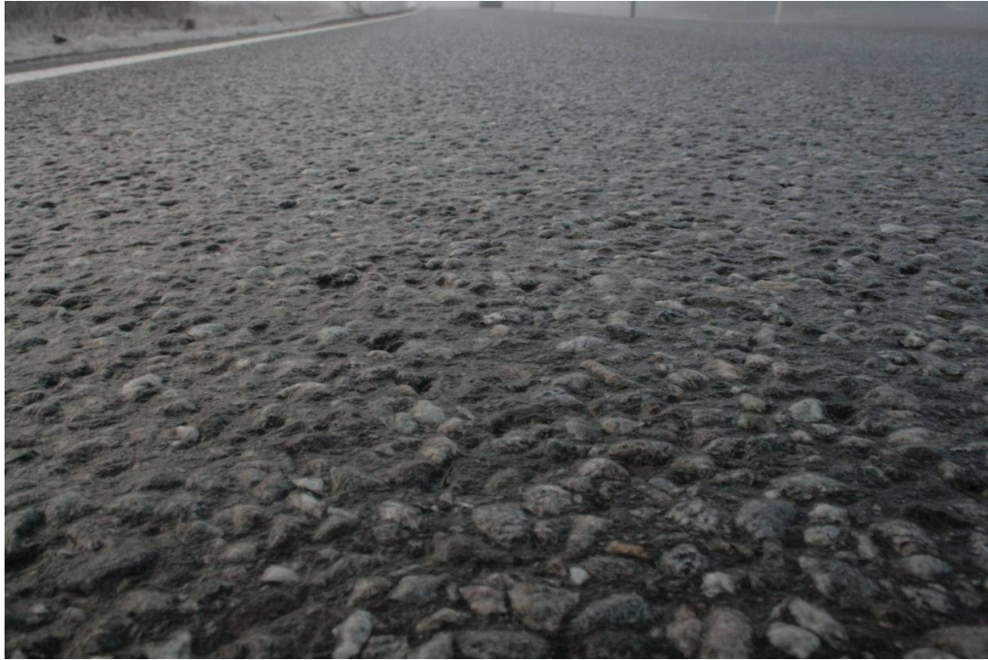
Figur 51: Vegbanen ved V2 ( Referansedekke Ska11 ) kl 07:33. Vegbanen har tydeleg fritt vatn til stades på overflata.
