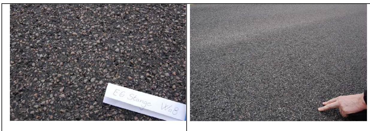
Figur 18: Foto av porøst dekke Wa8, E6 Stange, 15. mai 2008
