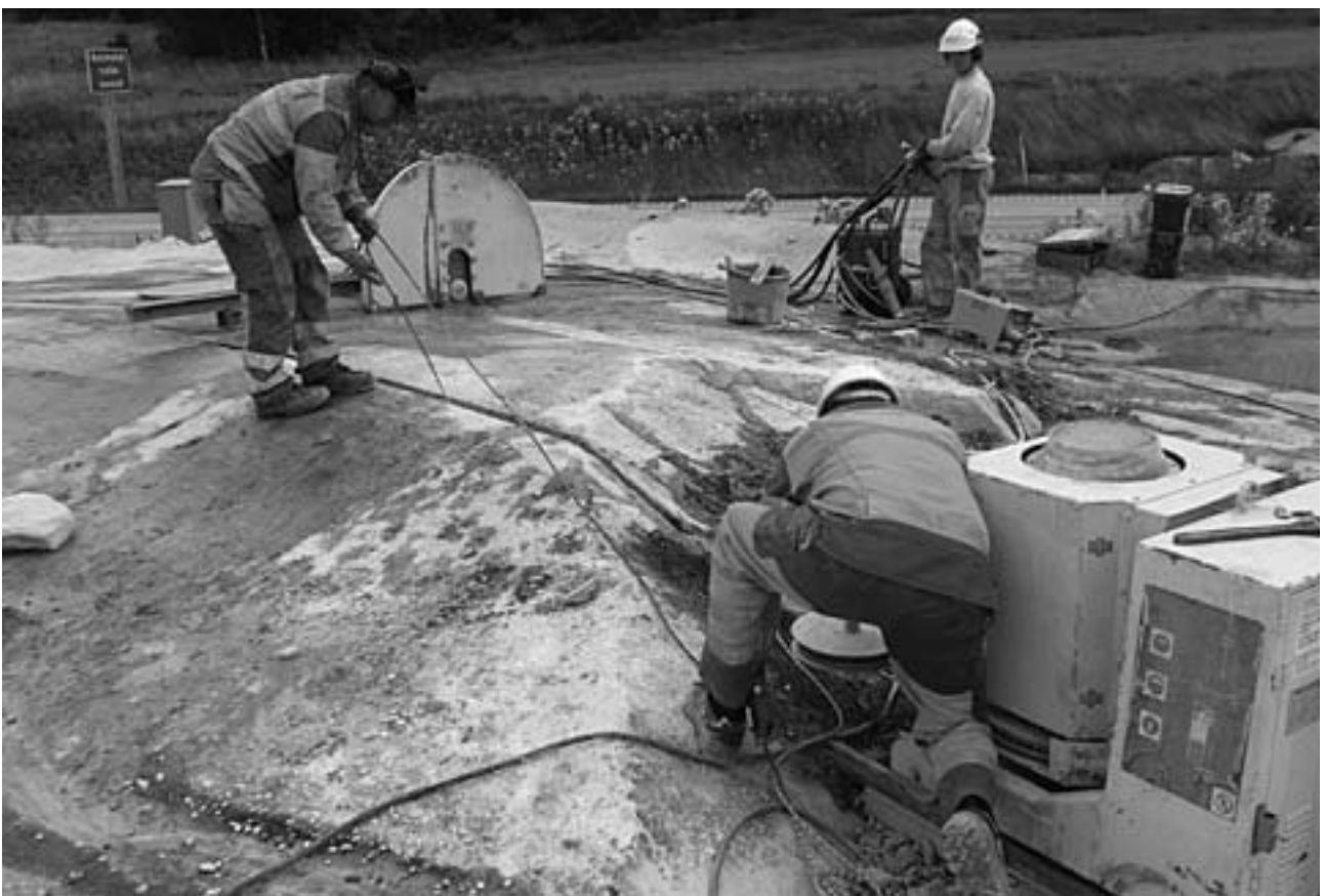
Figur 4_2: Utsaging av steinblokk ved hjelp av sirkelsag og vaier. Foto: E6-prosjektet Østfold, Kulturhistorisk museum.
