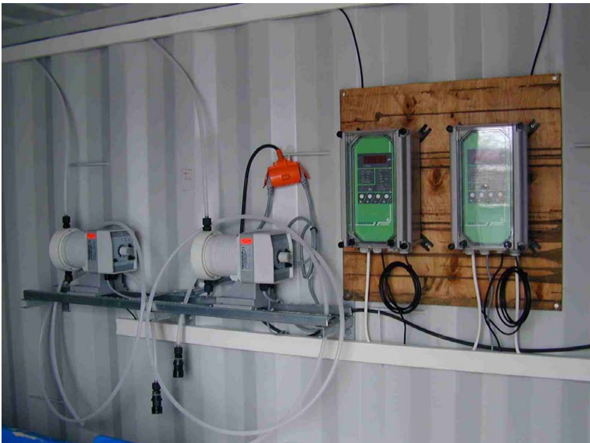
Figur 13. pH-loggere og pumper for styring av henholdsvis grov- og finjustering av pH med mineralsyre før utslipp til Isielva.
