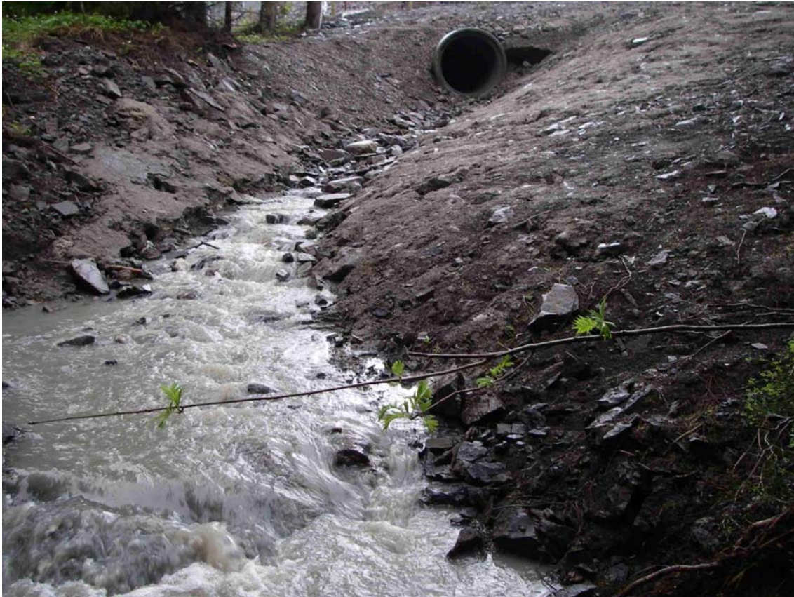
Figur 23. Kulvert og avrenning nedstrøms utløp fra massedepoiet på Lorangmyr. Fra mai 2006 hvor avrenningen var blakket med jordpartikler. Senere vannprøver har vist lavt innhold av partikler.
