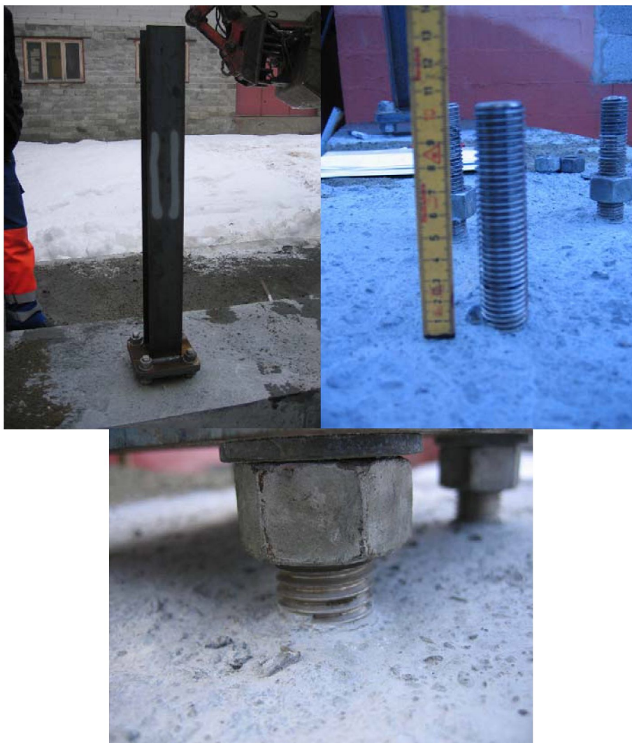
Figur 11: Typisk deformasjon ved fotplaten for stolpene 10 til 12
