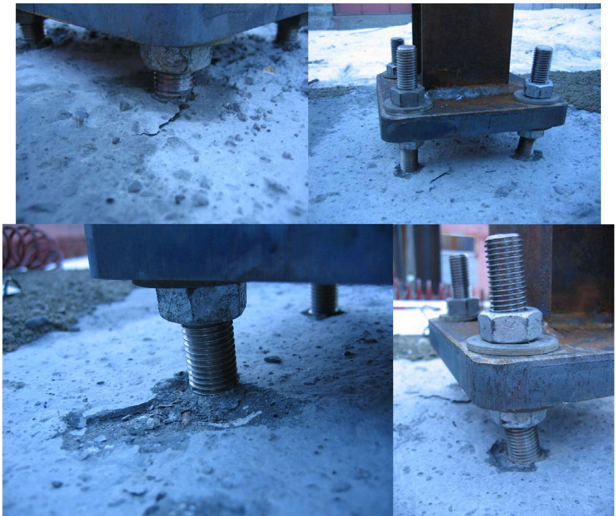
Figur 9: Typisk deformasjon ved fotplaten for stolpene 4 til 6
