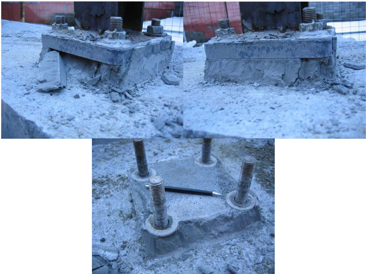
Figur 10: Skader på understøp for stolpene 7 til 9
