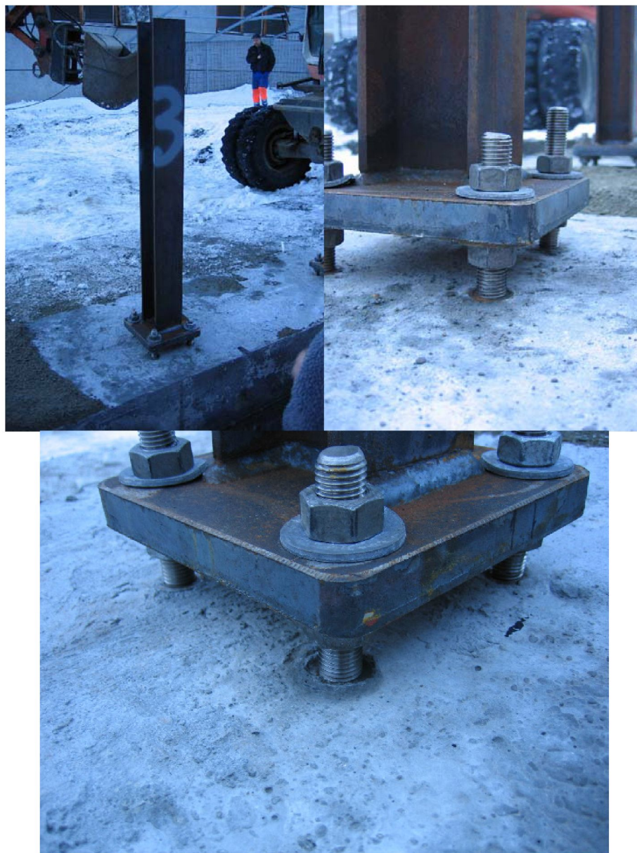
Figur 8: Typisk deformasjon ved fotplaten for stolpene 1 til 3
