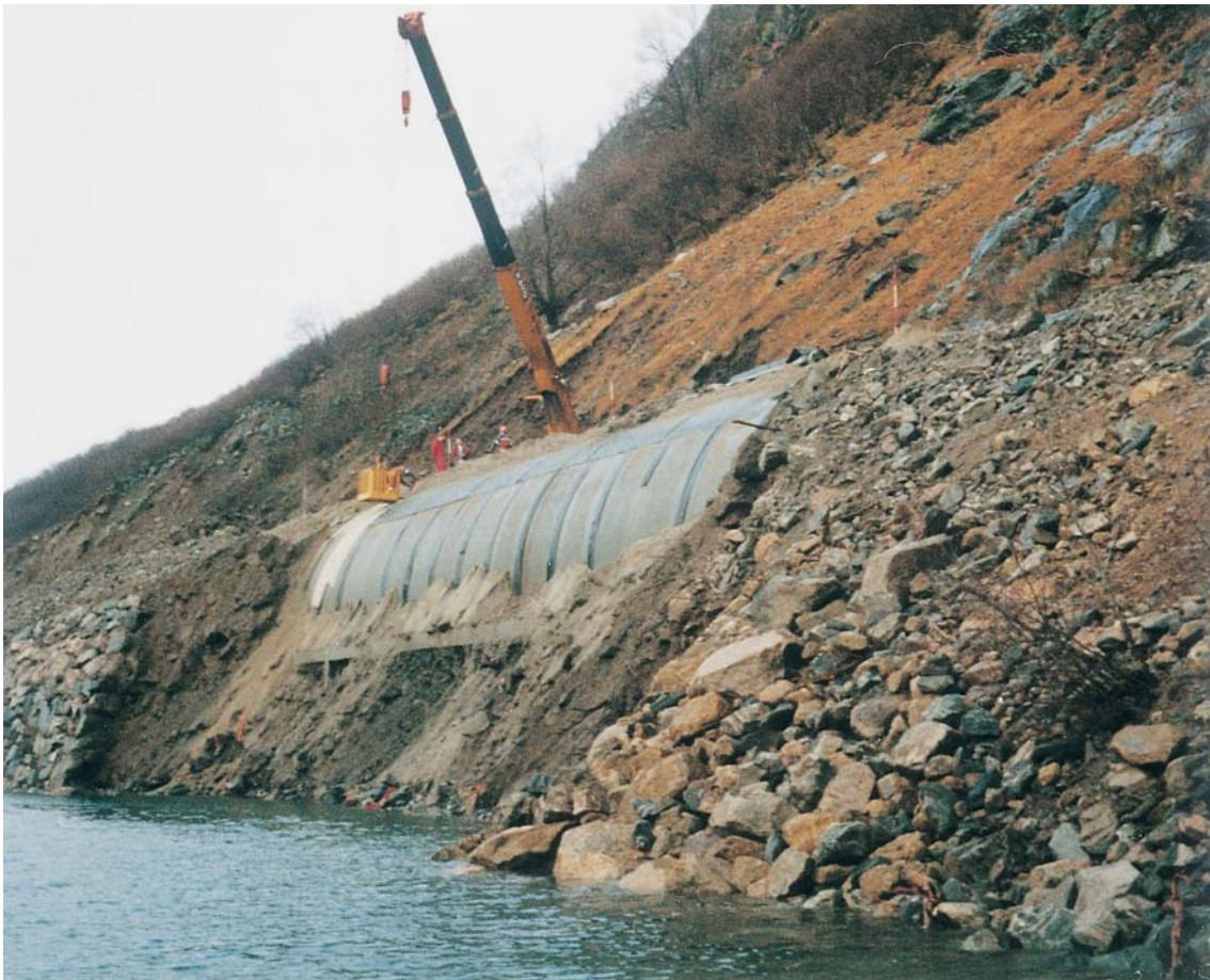
Bilde 16: Rasområdet (ca. 40 m lengde) og ustabil tørrmur ved rasoverbygget.
