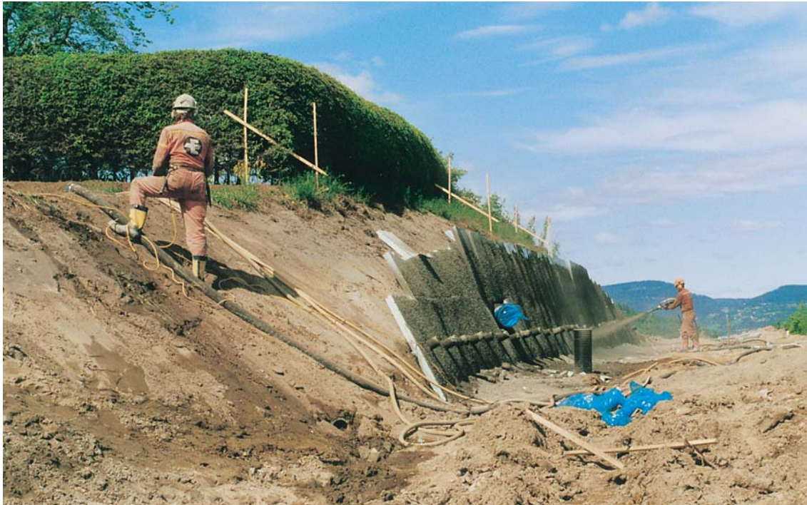
Bilde 3: Første nivå med kombinerte drens- og isolasjonsplater påføres 1. lag av sprøytebetong. Merk rørstussene for lettere gjennom boring ved stagsetting og enklere kontroll av tykkelse på betongen.
