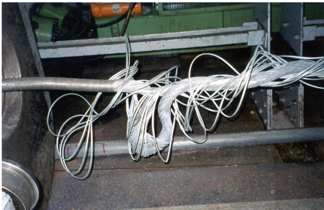
Foto 7. Suppleringskabel strukket til brudd
