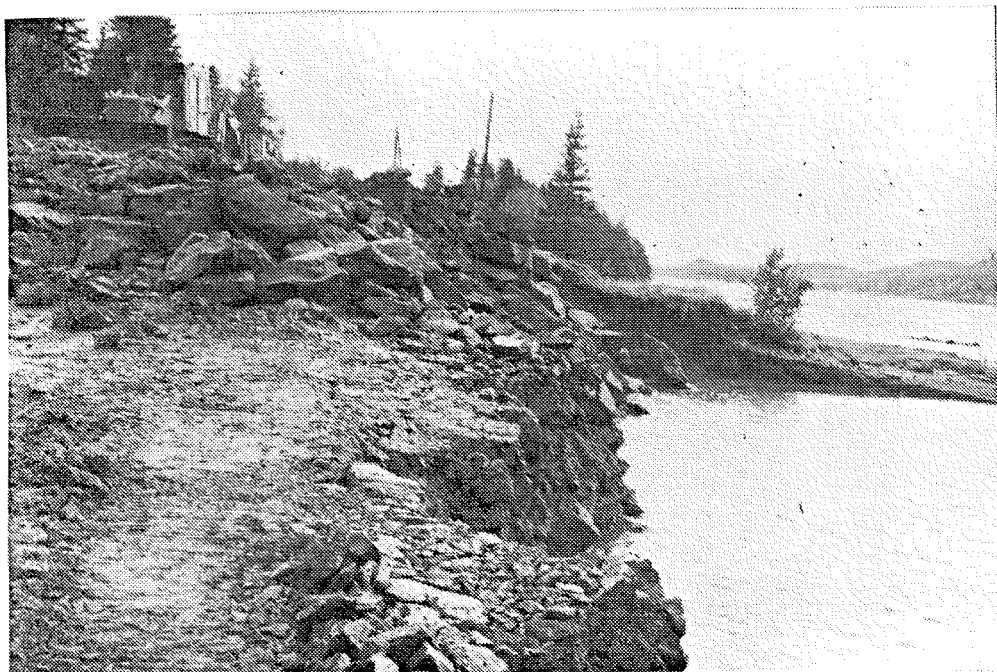
Bilde 27: Etter utrasing av tunge fra pr. 3860 til 3785.
