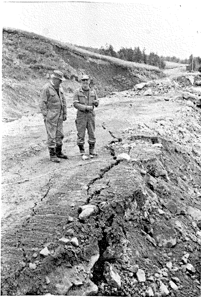
Bilde 20: Langsgående sprekker i planum etter sprengning langsetter fyllinga.
