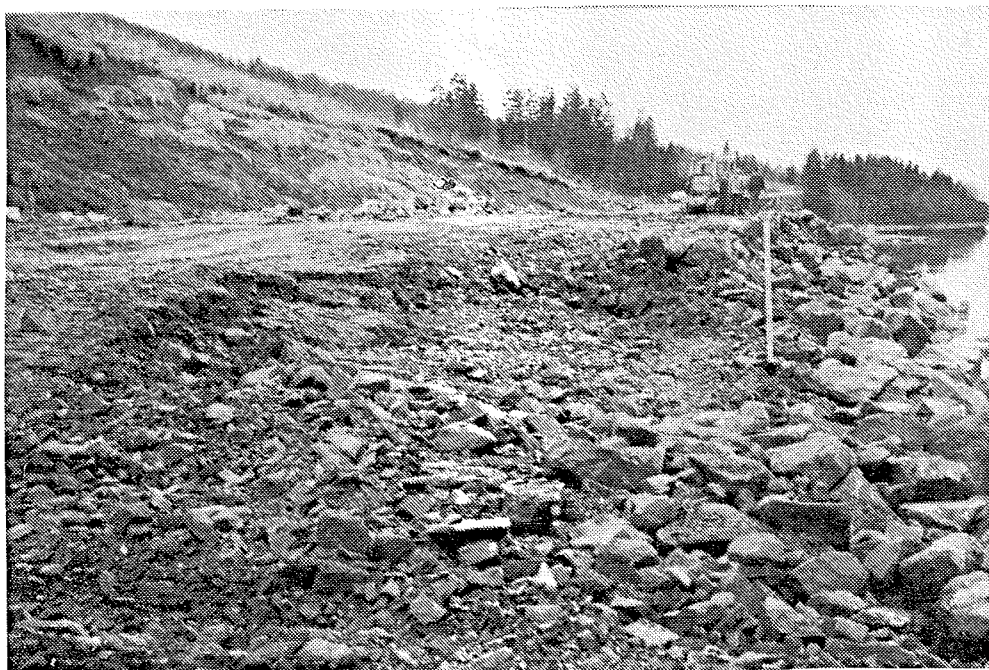
Bilde 33: Største synk i forbindelse med ettersprengningen er ca. 0,5 m.
