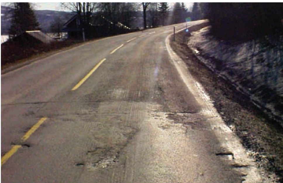
Figur 7. Foto fra riksveg 212 den 19.4.2006 km 2,892 (lokal strekning med store IRI-verdier, se figur 5).
