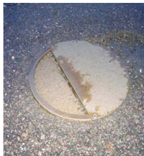
Figur 31: Topplate nedsunket i veg [34]
