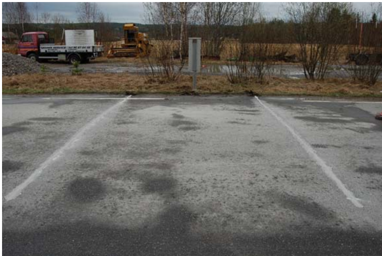
Figur V24.7. Nedlagte kabler for registrering av aksellast og totalvekt på fylkesveg i Hedmark, april 2009.
