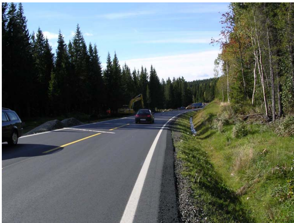
RV 33 i Oppland på strekningen Gjøvik-Dokka. Punket i sør, bildet tatt med kilometreringsretningen (retning Dokka).
