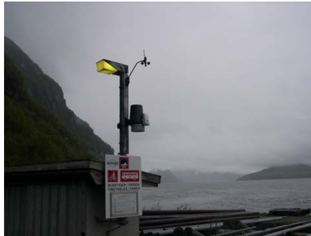
Figur 2 - Temperatur- og fuktighetssensor montert utenfor Innfjordtunnelen.
