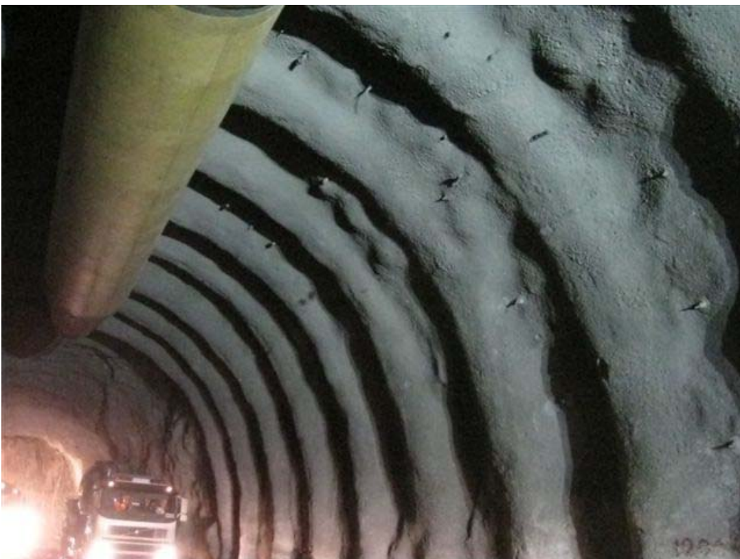
Figur C.4 Sikring med armerte sprøytebetongbuer, Ringveg vest 2008 (foto: T. Kirkeby).
