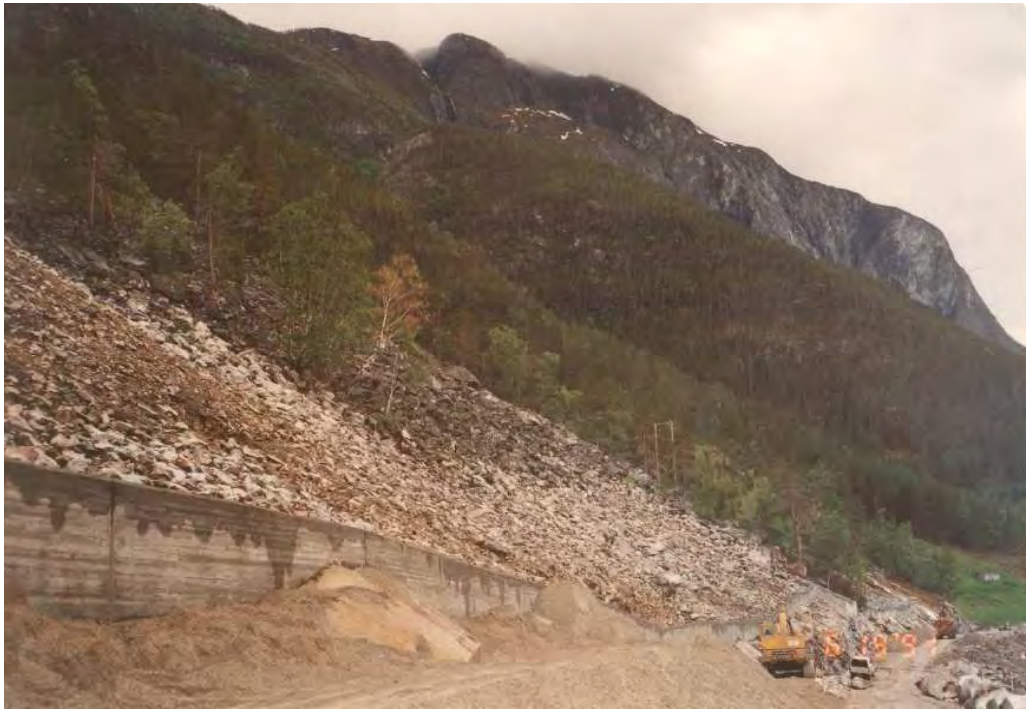
Figur 3-3- 9 Plasstøpt betongmur på fjellfot som sikring på Rv. 53 Naddvik – Fornes, Sogn og Fjordane. Stabilisering av ura på oversiden av mur med ordnet steinfylling (Foto: E. Husabø).
