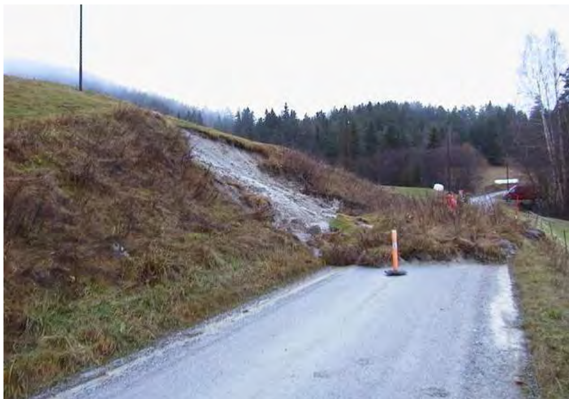
Figur 3-2- 8 Eksempel på overflateglidning (Foto: Bjørn K. Dolva, Region sør).
