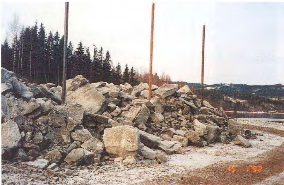
Figur 2-3- 10 Fylling for bruhode med setningsmålere der forbelastning delvis er lagt ut. Setninger måles ved nivellering av topp rør. (Foto: Nils Rygg, Veglaboratoriet)
