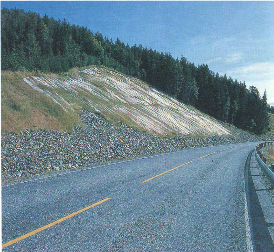
Figur 3-2- 22 Skråning i siltig morenemasse ved E76 i Morgedal. Partiet er et av de første forsøk med Eronet, utført i 1982. Skråningen har bare hatt helt ubetydelige skader etter sikringen, (Foto: Birger Aase).
