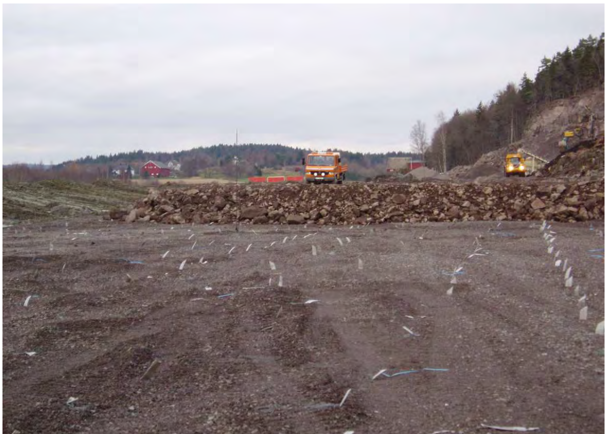
Figur 1-6- 11 Bildet viser installerte vertikaldren hvor oppfyllingen og forbelastningen kommer fortløpende etter. (E18 Kopstad – Gulli 2004 – foto C.E. Dahl)
