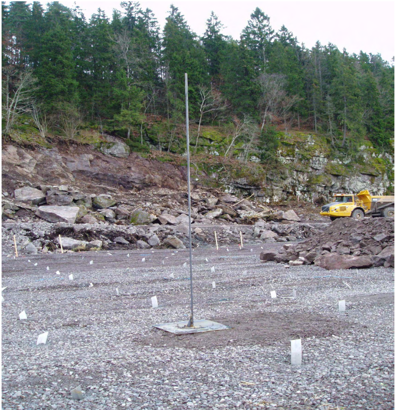
Figur 1-6-9 Bildet viser installasjon av tradisjonell setningsmåler med plate og stang. Platen plasseres på grusputen/drenslaget, og beskyttes med et stålørnsom fylles med grus. (E18 Kopstad – Gulli 2004 – Foto: C.E. Dahl)
