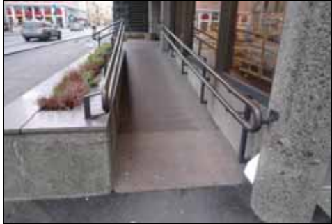
Bilde 47 Bergen. Rampe med rekkverk i to høyder som gir enkel bruk for både rullestolbrukere og gående og rampen har en bredde som gjør at en kan bruke rekkverk på begge sider samtidig. Rekkverket har god kontrast mot omgivelsene og det er forlenget ut over begynnelse på rampen på en side. Det er kontrast mellom belegg på bakken og rampen.
