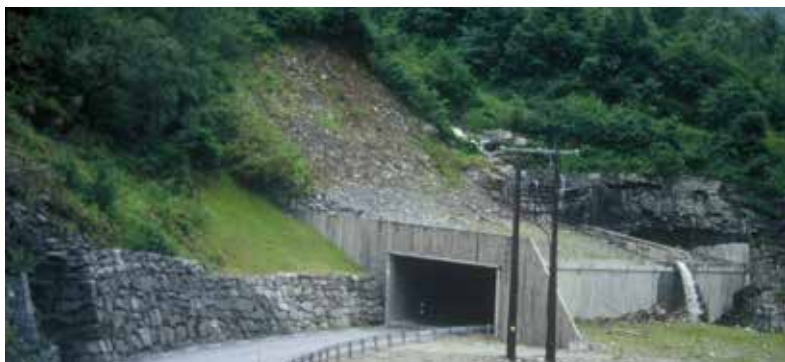
Figur 8.1 Eksempel på skredoverbygg som fungerer som en forlenget tunnelportal. Endeavslutningen er utformet med en ledemur som er trukket inn mot ledevollen og har en vinge på utsiden av overbygget for å hindre tilbakeslag av skredsnø inn mot vegen. Overflatevannet er ført i en egen renne over overbygget. Fv. 615 Hyenfjorden, Sogn og Fjordane Foto H. Norem
