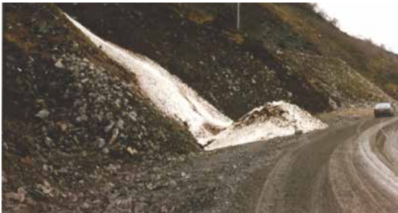
Figur 8.32. Eksempel på en bred grøft som har stoppet et mindre skred. Lisjestreket, fv. 65, Hjørundfjorden, Møre og Romsdal. Foto: H. Norem
