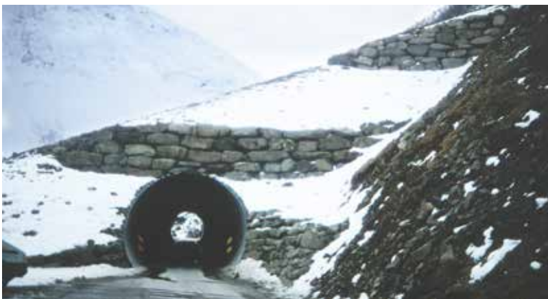
Figur 8.9 Eksempel på overbygg bygget med korrugert stålør og sikring av portalen med en ledevoll av tørrmur. Longeneset, fv 60 Hjørundfjorden, Møre og Romsdal. Foto H. Norem
