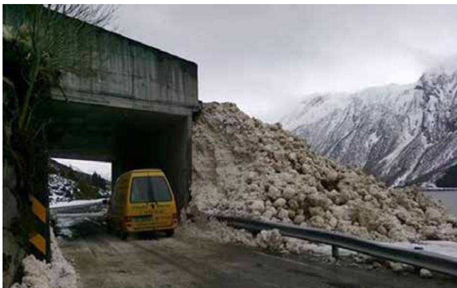
Figur 8.6 Foto av et kort overbygg hvor skredmassene som har passert overbygget har blitt stuvet opp mot terrenget utenfor og sperret vegen. Fv. 40 Remegjølet, Hjørundfjorden, Møre og Romsdal. Foto A. Hustad
