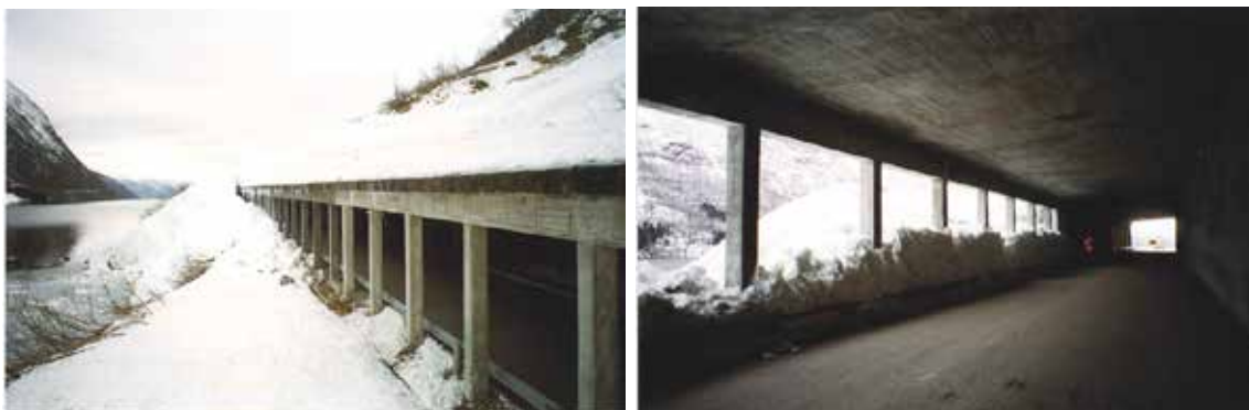
Figur 8.4 Foto av overbygg med åpen frontvegg, og hvor skredsnø har trengt inn i overbygget. Rv. 13, Ramsteina, Sogn og Fjordane. Foto: H. Norem
