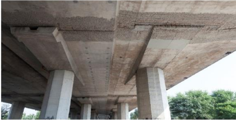
Figur 30. Undersidan av bron där det katodiska skyddet skall installeras vid fogen.
