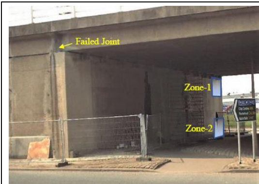
Figur 45. Bro nr 2. Installerade offeranoder monitorerades i zon 1 och zon 2.
