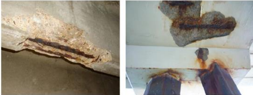
Figur 18. Korrosionsskada på parkeringsdäcket till vänster och den mindre bron till höger. Skadorna var orsakade av höga kloridhalter i betongen.
