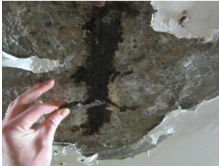
Figur 61B. Delaminerad betong p g a armeringskorrosion i betonggolv
