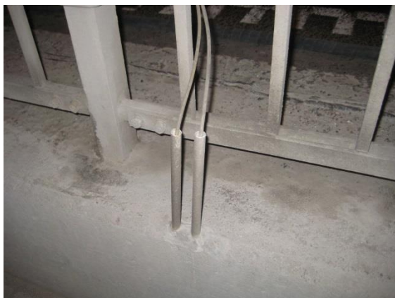
Figur 42B. Inmonterade mätelektroder i stödmurens kantbalk (Essingeleden). Utstickande kablar skyddas av ett utvändigt plaströr.
