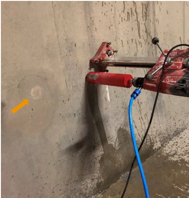
Figur 14 Utboring av kjerner i 2020, høyde ca. 0,8 m over bankett. Reparert borhull fra 2015 til venstre på bildet (merket med pil). Foto: Stig Henning Helgestad, Statens vegvesen
