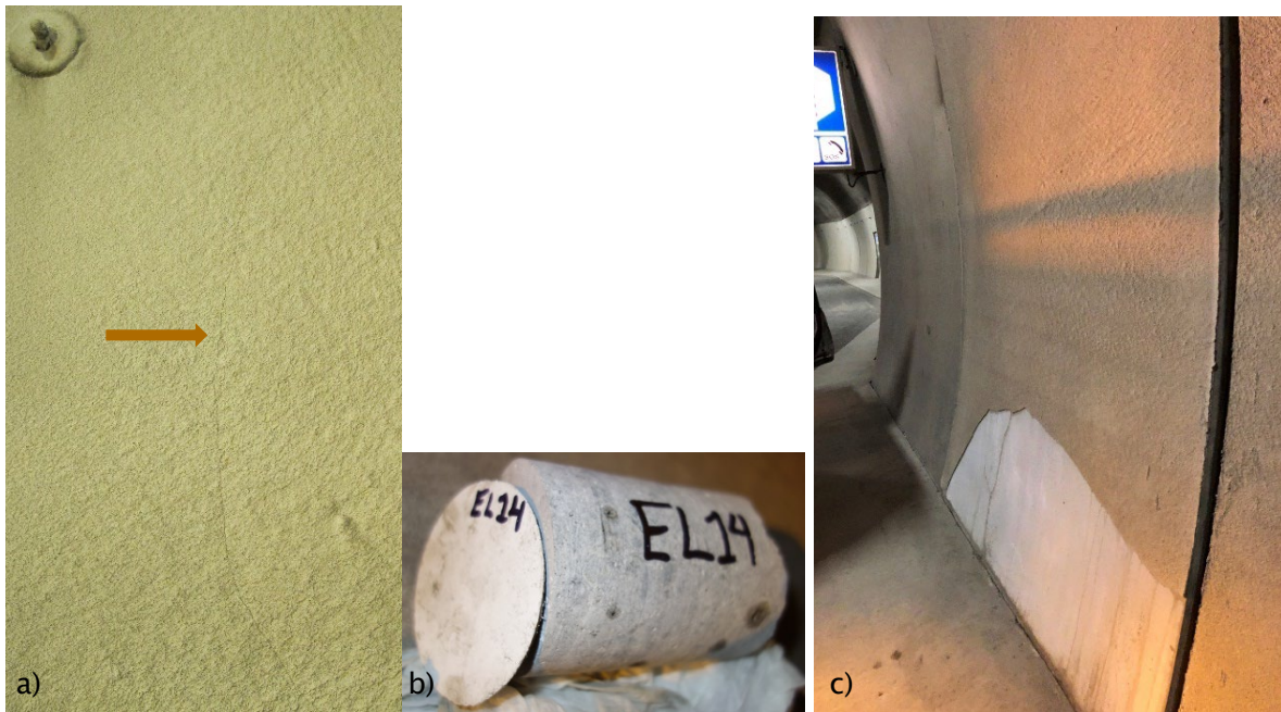
Figur 15 Foto av overflate med Cempro Whitecoat a) Riss i belegget i 2015 (merket med pil) b) Heftbrudd etter utboring av kjerne i 2015 og c) Avflaking av større område i 2020. Merk at i 2015 (etter vask) er belegget lysere enn betongoverflata bak, mens det i 2020 (før vask) er mørkere enn betongen bak. Foto: Stig Henning Helgestad, Statens vegvesen
