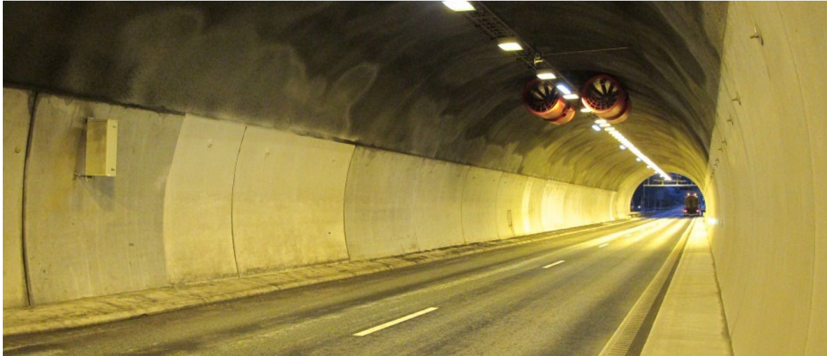
Figur 8 Oversikt - fra element nummer 15 - etter vask juni 2011. Foto: Eva Rodum, Statens vegvesen.
